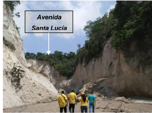
Fotografía 10. Vista desde la parte inferior del canal hacia la Avenida Santa Lucía. Se observan derrumbes de material de las márgenes del mismo.
