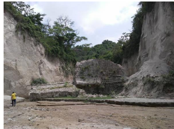
Fotografía 8. Muro colapsado de las obras de mitigación construidas en el año 2008, por el Ministerio de Obras Públicas.
