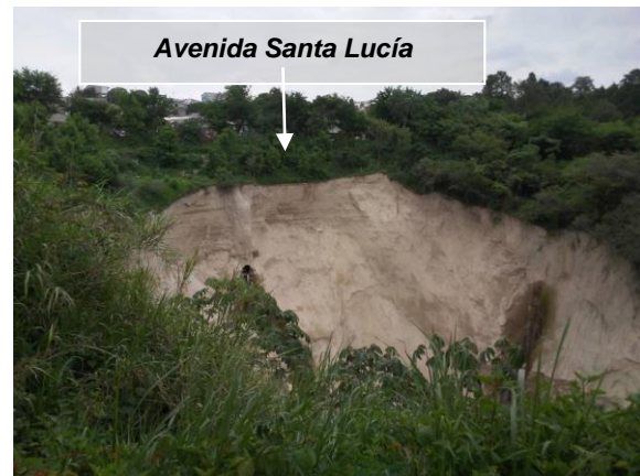
Fotografía 6. Vista frontal de la cárcava donde pueden observarse las descargas de aguas lluvias y negras que han originado la erosión en la zona.
