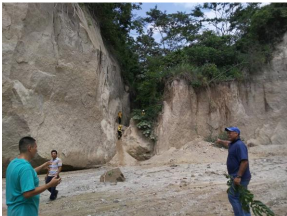
Fotografía 7. Vista del acceso hacia la parte inferior del canal. Nótese el material de las márgenes que presentan desprendimientos constantes.
