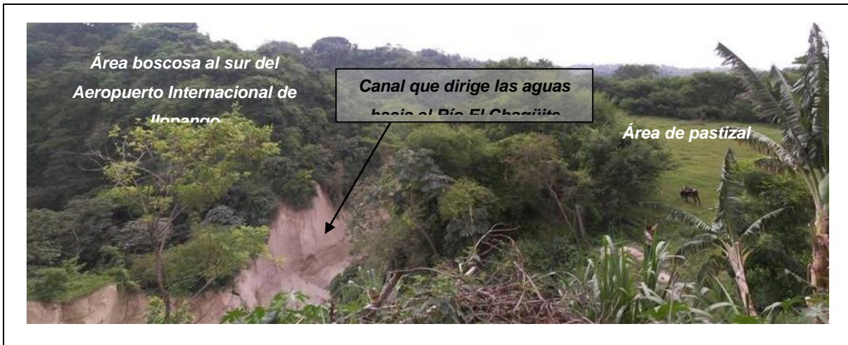
Fotografía 4. Vista de los terrenos colindantes del canal formado por las descargas. A la izquierda colindancia sur de la cárcava donde se ubican áreas de terreno que son utilizadas como área de pastoreo para ganado.
