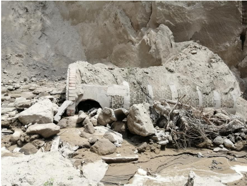
Fotografía 2. Pozo de aguas lluvias colapsado, el cual se encontraba ubicado en la huella de la berma.
