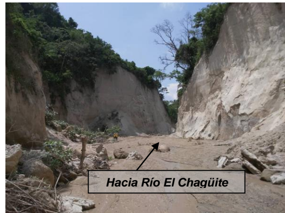
Fotografía 12. Presencia de daños en la superficie de rodadura sobre la calle de acceso a la colonia.
