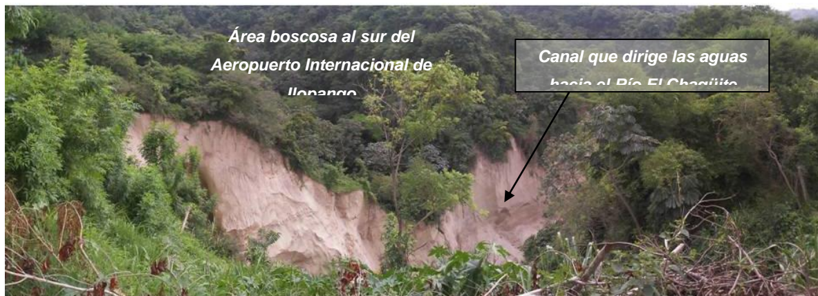
Fotografía 3. Costado norte de la cárcava Santa Lucía, zona boscosa en el lindero sur del Aeropuerto Internacional de Ilopango. Obsérvese el tipo de suelo que constituye los márgenes del canal.
