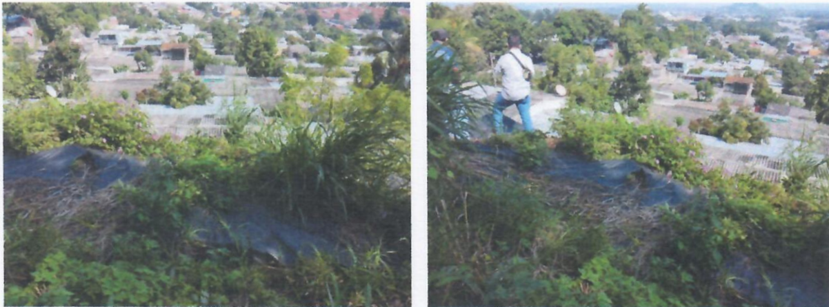
Imagen 3 Vista del deslizamiento desde la parte alta del talud
