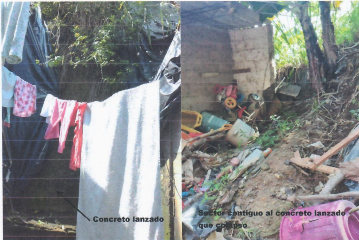
Imagen 8 Daños en las casas por deslizamiento en el talud contiguo a vivienda
