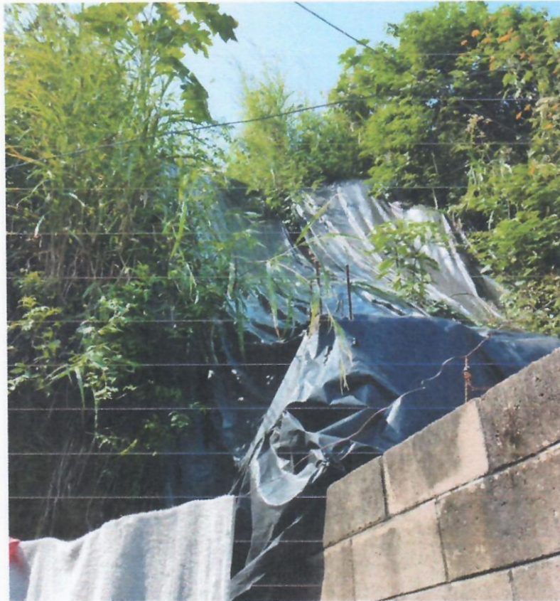
Imagen 4 Vista del deslizamiento desde la parte baja del talud contigua a viviendas
