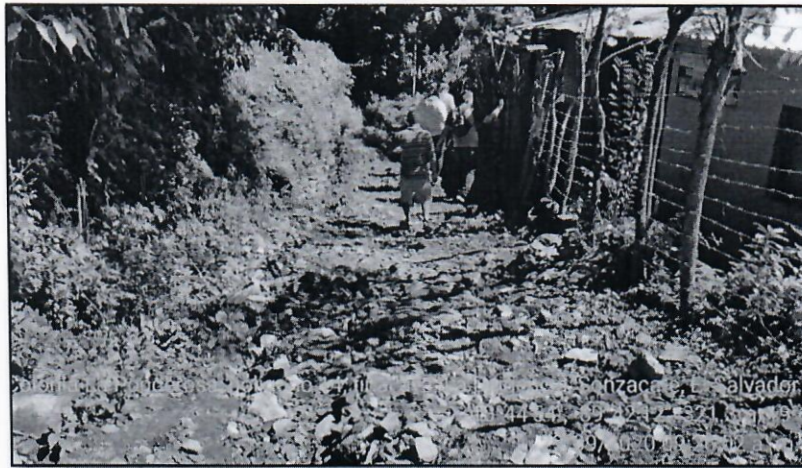
Fotografía N° 3. Estado de deterioro de camino de acceso hacia cruce por ríos Negro y Ceniza.
