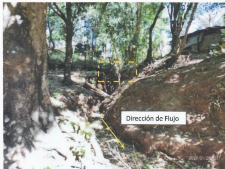
Figura 4. Vista de la intersección de la vaguada con la Ruta LIB22S
