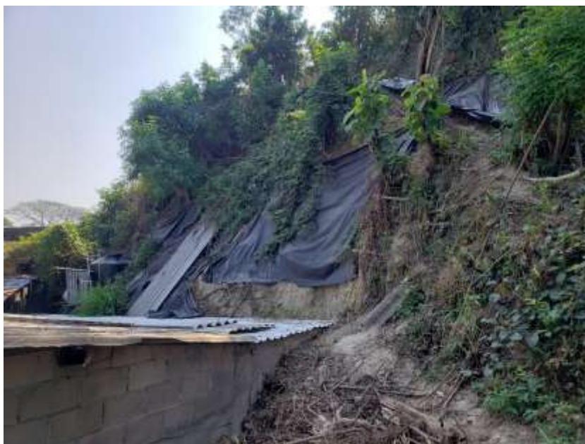
Figura 3. Vivienda afectada; vista desde costado sur de vivienda; nótese corte de pie de talud
