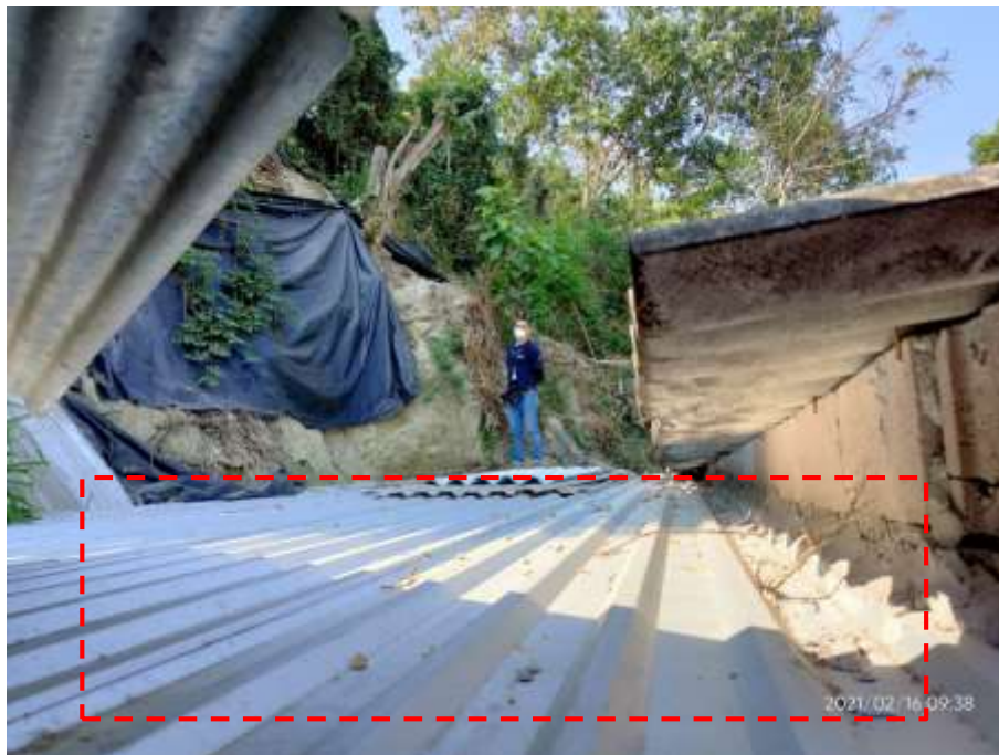
Figura 2. Cicatriz del deslizamiento y zona de ampliación. Vista desde costado norte de vivienda.
