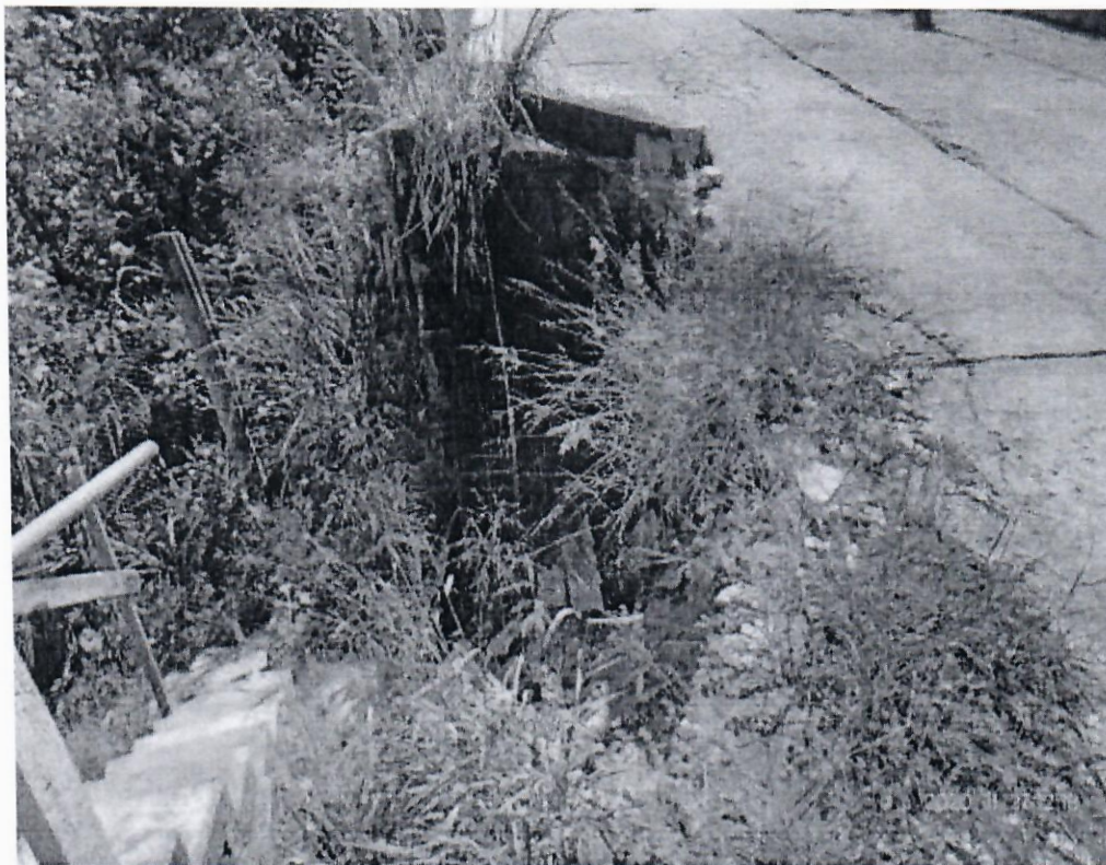
Fotografía N°1. Vista general de porción de muro colapsado.
