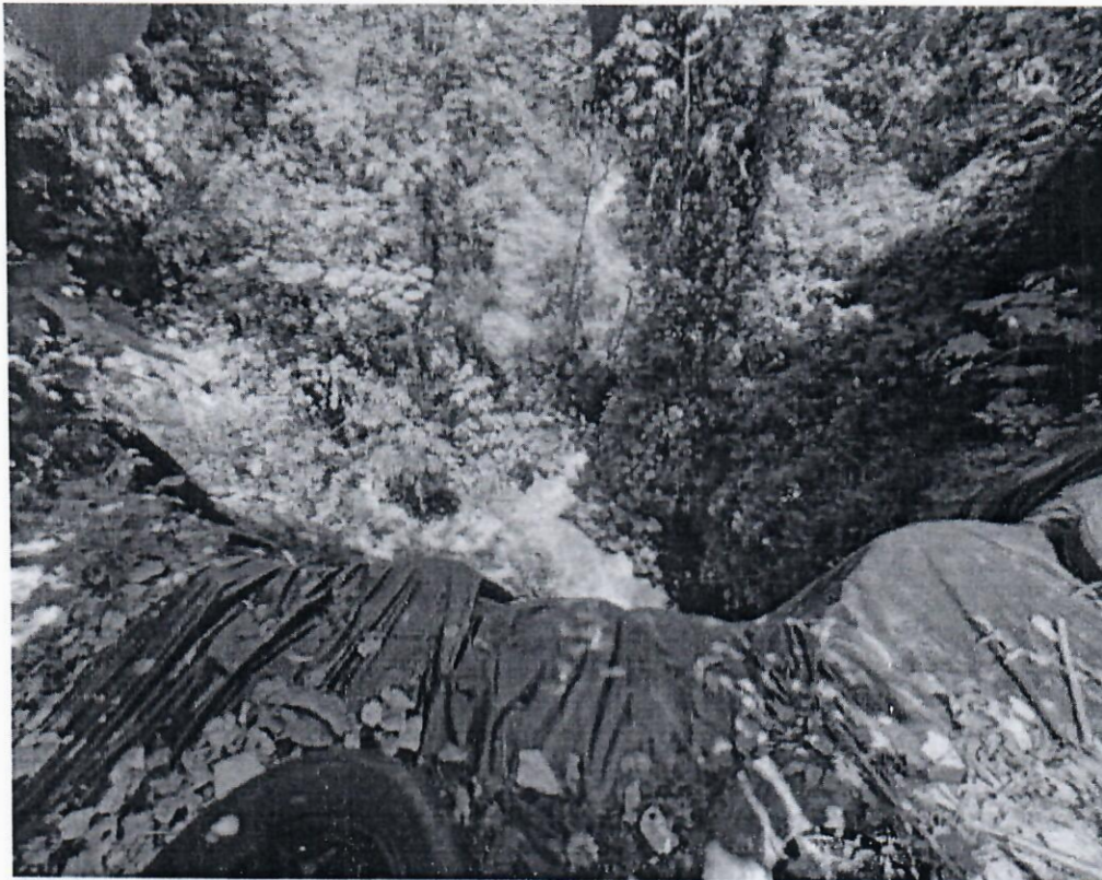
Fotografía N°7. Vista de cárcava.
