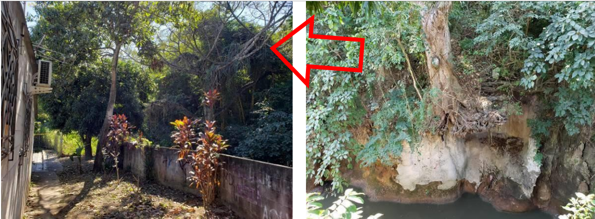
Imagen 4 Árbol que amenaza con caer sobre viviendas de la Residencial
