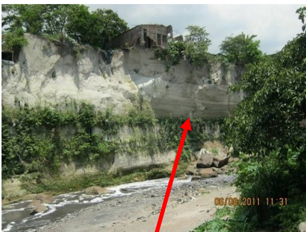
Fig.6 Socavación en el talud. (Lat. Izquierdo)
