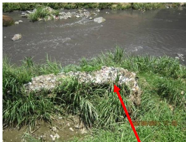
Fig.3 Muro de Gaviones existente Socavado. (Lat. Izquierdo)
