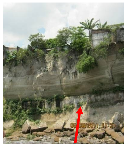
Fig.7 Presencia de vegetación en el talud, lo que indica existencia de agua subterránea en el mismo. (Lat. Izquierdo)
