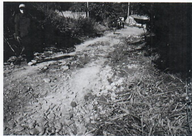
Imagen 4 Zona con daños en rodaje
