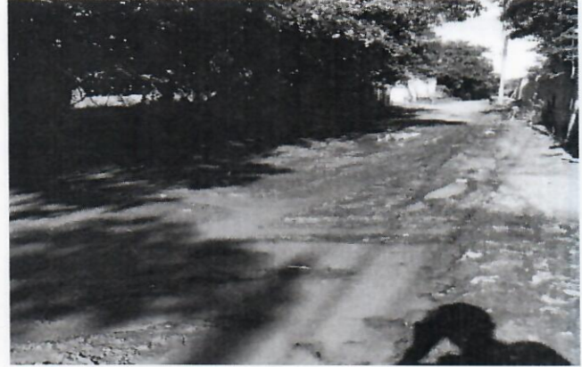
Imagen 2 zona con empozamientos de agua
