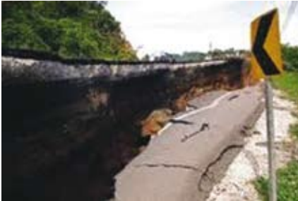
Daño a carretera por sismo en Honduras 29 de mayo (San Pedro Sula)
