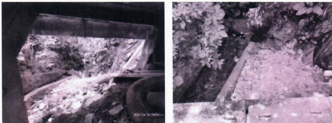
Fotografía 3. Vista de estribo sur a) desde la parte inferior b) desde la plataforma del puente.
