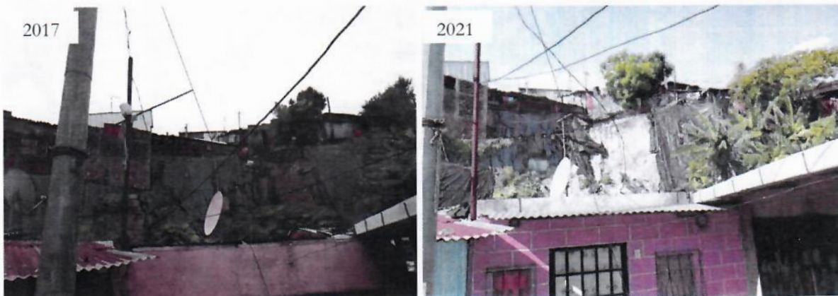
Figura 3. Comparación del estado del taludes vista desde el frente de la clínica comunal
