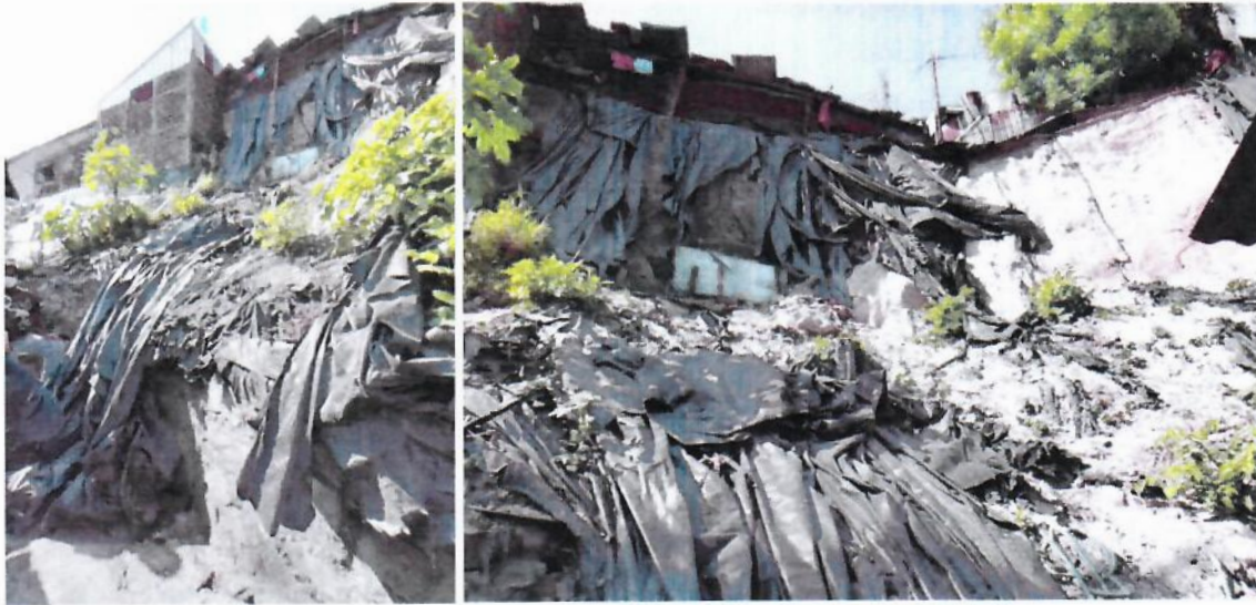
Figura 2. Talud de la comunidad de la fosa tomando desde su base.
