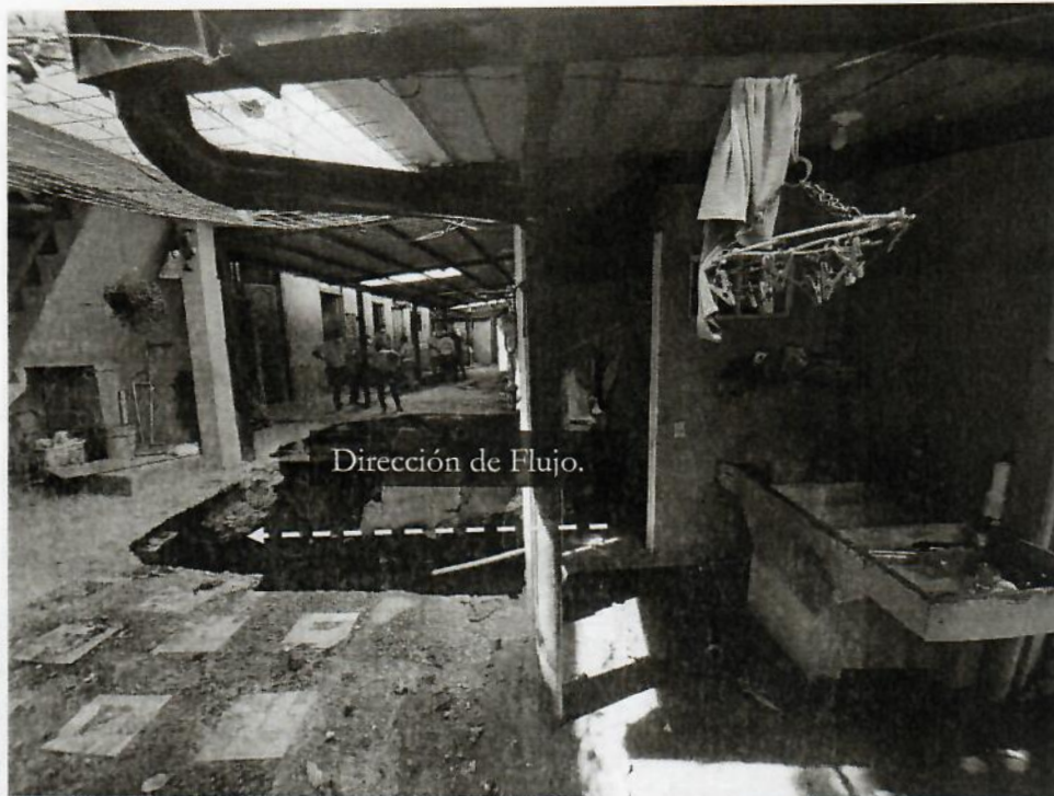
Fotografía 3. Servicios Sanitarios sin apoyo debido a la formación de cárcava.
