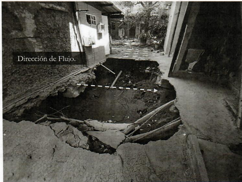
Fotografía 2. Cárcava en formación al interior de la vivienda 761, al fondo habitaciones sin acceso por cárcava.
