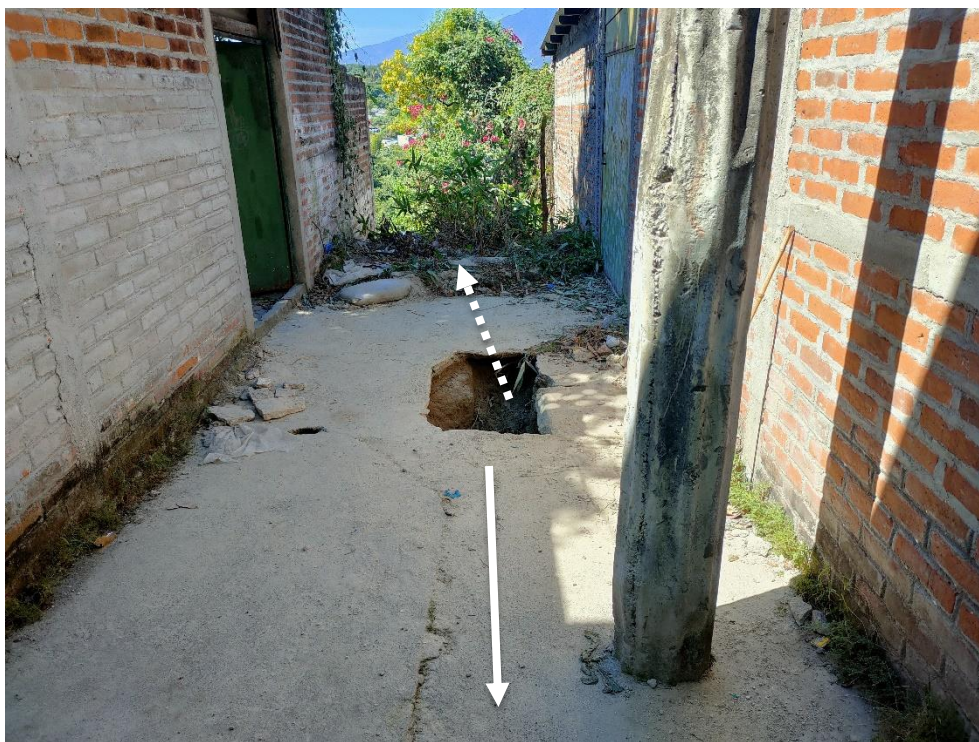
Figura 4. Vista de afloramiento de agua en cortes.
