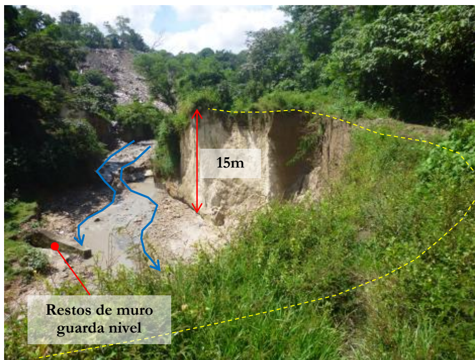
Imagen 5. Condiciones encontradas en margen izquierda de Río Sumpa, sector crítico entre final Calle Veracruz y final Pasaje San Miguel. Fotografía tomada con vista hacia aguas arriba.
