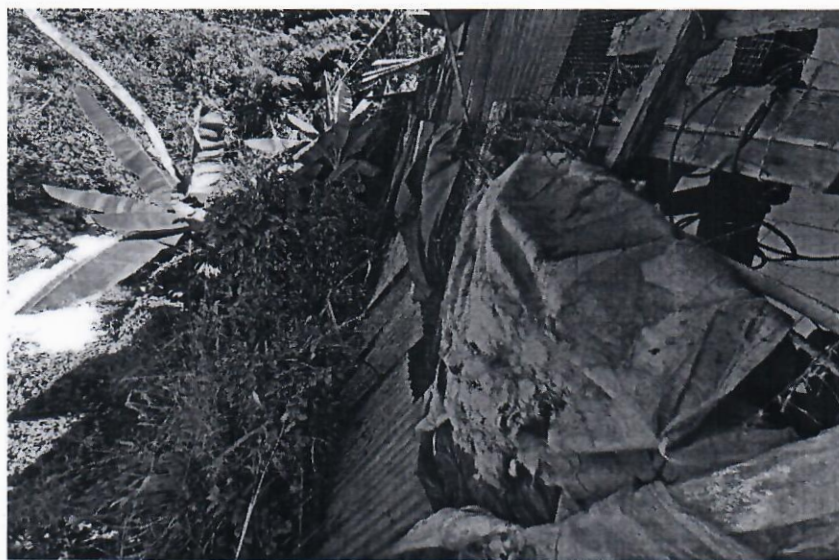
Figura 4. Zona de colapso de muro perimetral de casa #1; espacio de vivienda inutilizado por seguridad de sus habitantes
