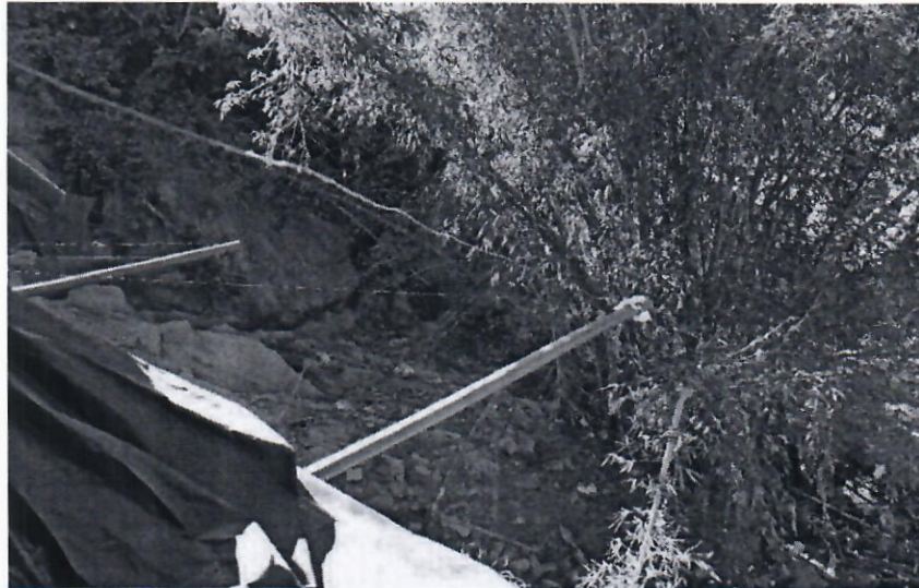
Figura 6. Vista de deslizamiento al fondo de la casa # 16. Obsérvese la presencia de tuberías de descarga directamente sobre cuerpo de talud.
