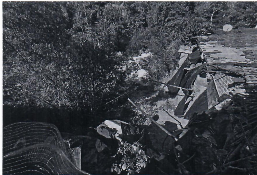
Figura 7. Vista del deslizamiento desde final Pasaje #6.
