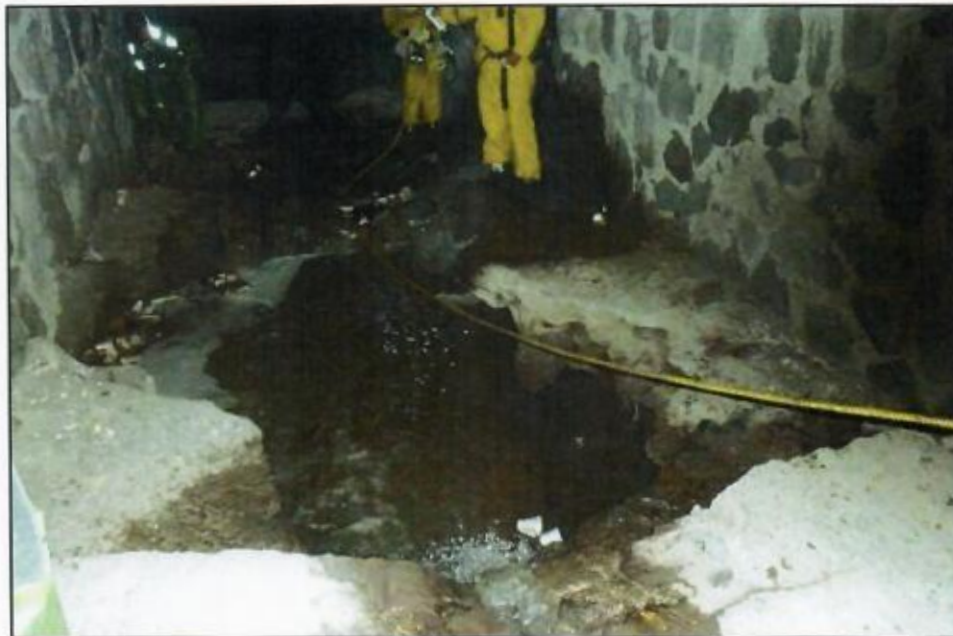
Fotografía 14. Socavación severa en cama de agua y paredes laterales (0+180)
