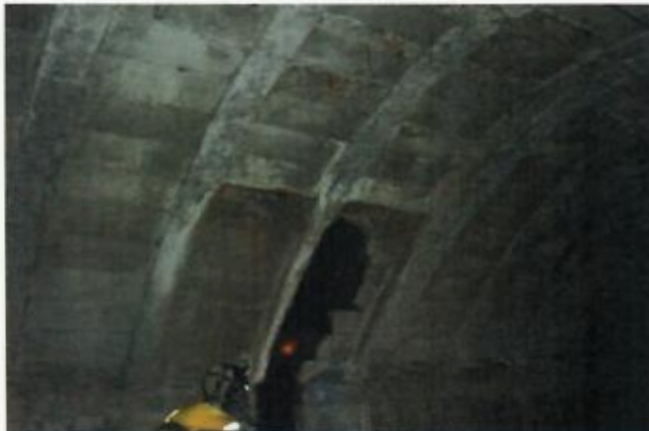
Fotografía 32. Descarga a través de 7 bovedillas fracturadas.
