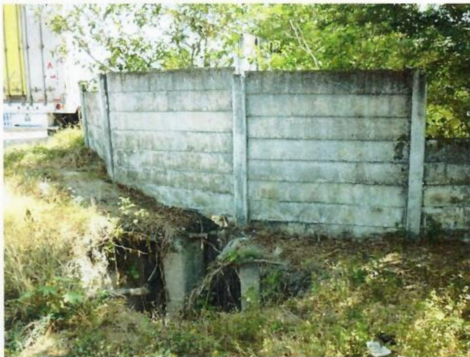
Fotografía 17. Cárcava y muro expuesto parte superior descarga de bóveda
