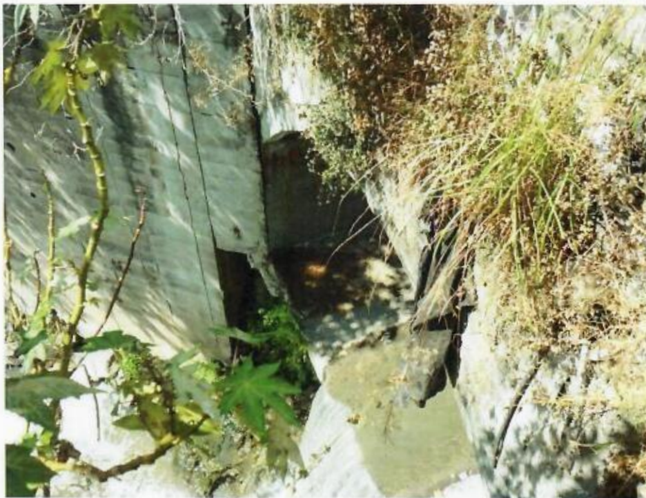
Fotografía 20. Agrietamiento en muro dañado.
