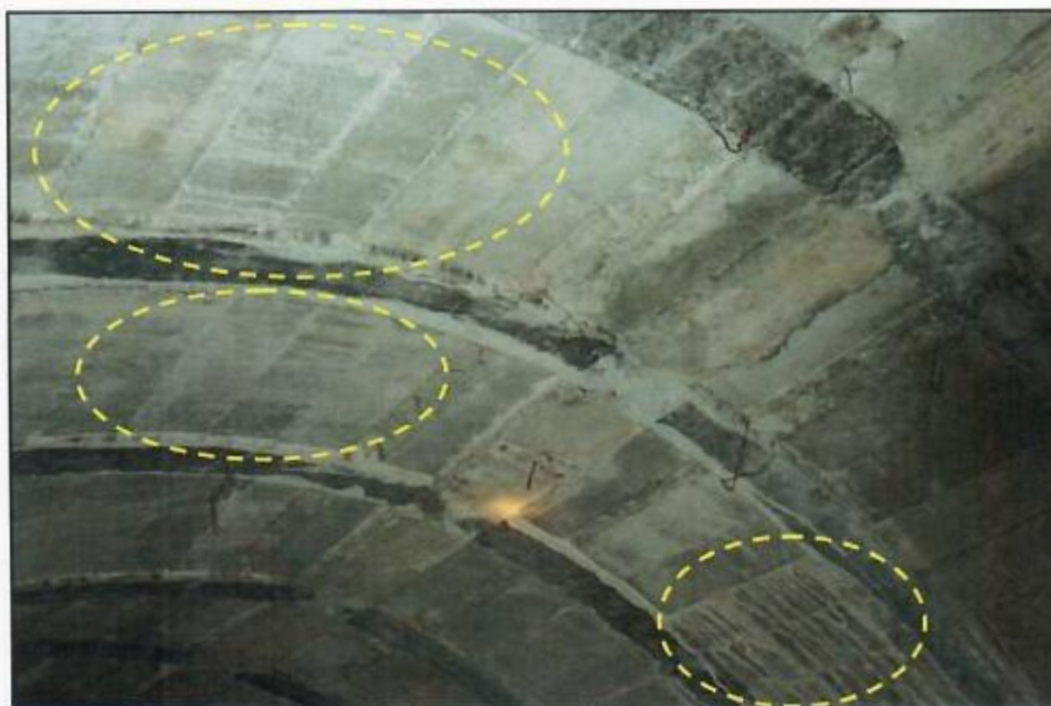
Fotografía 24. Infiltraciones en bovedillas del arco.
