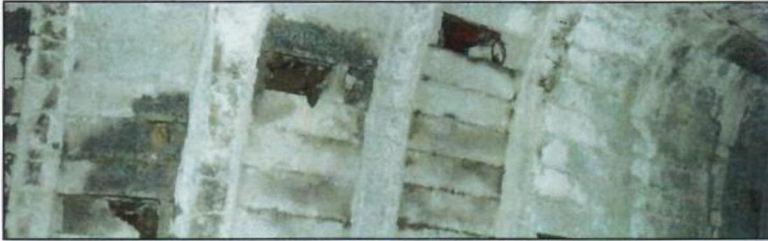
Fotografía 5: Infiltraciones en bovedillas. (0+050 – 0+070)
