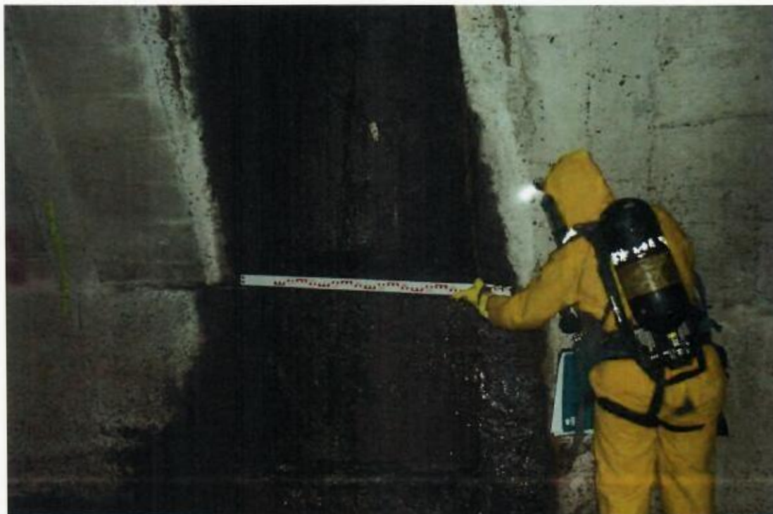
Fotografía 30. Entrada de pozo de A.LL., existe deficiente descarga de agua manteniendo en condiciones de humedad lateral de bóveda. (0+480)
