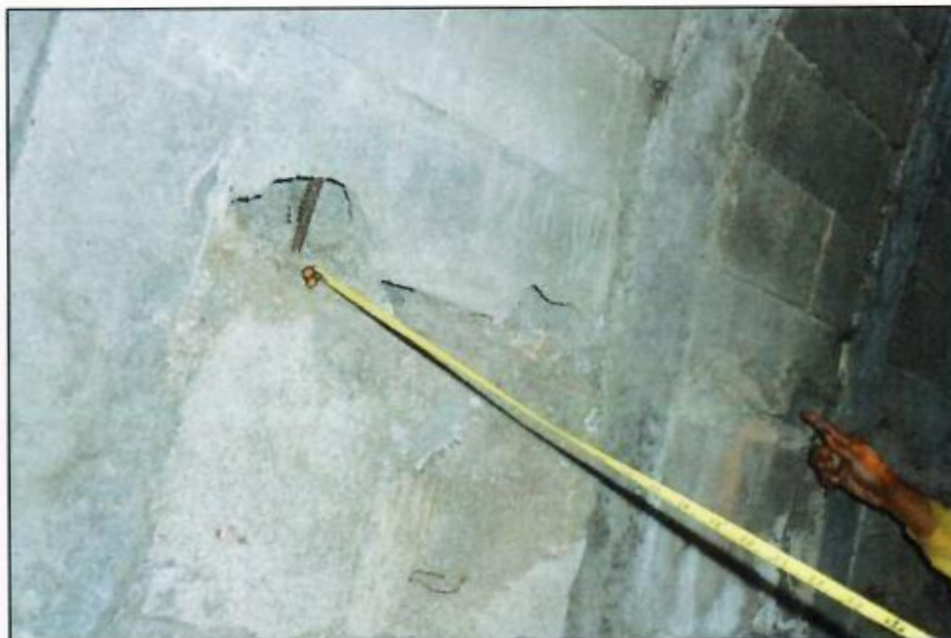
Fotografía 23. Vicios constructivos: acero de refuerzo expuesto y bovedillas fracturadas.
