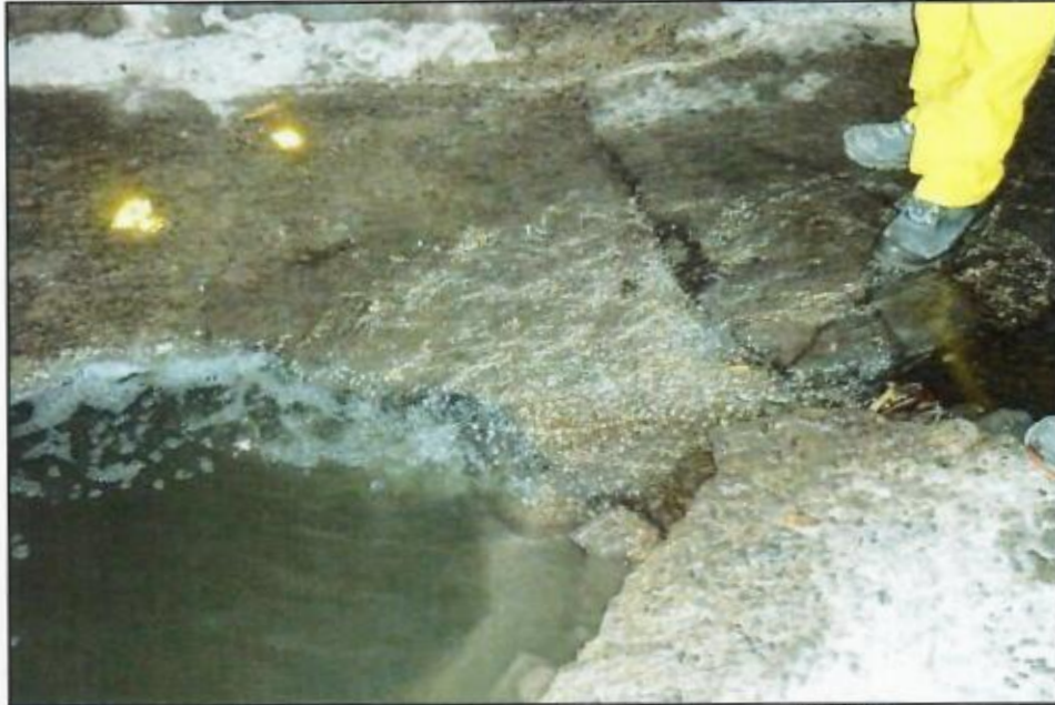
Fotografía 3. Pérdida parcial de cama de agua. (0+040)
