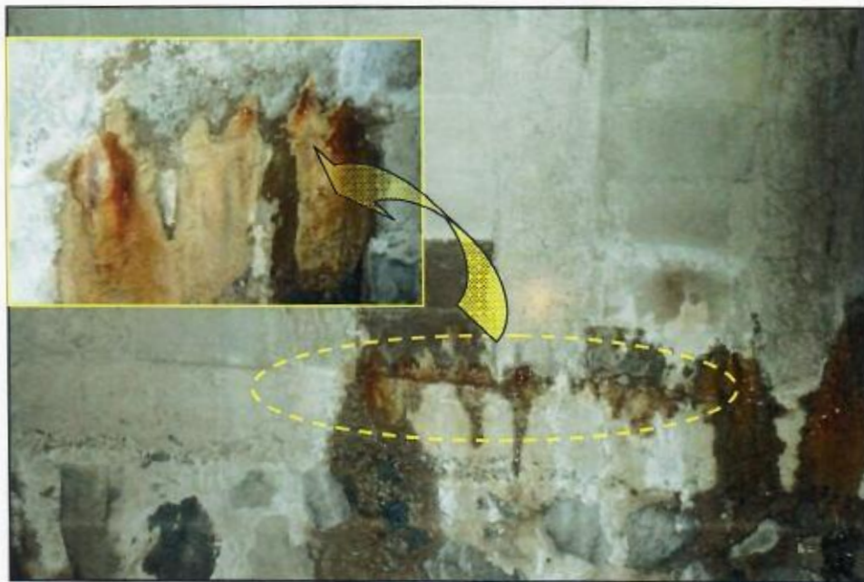
Fotografía 10: Infiltración en zona de unión arco – pared lateral (0+110).
