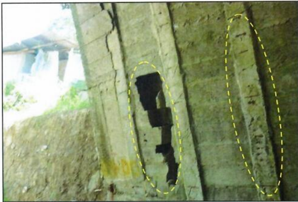
Fotografía 1. Daños en bovedillas y acero de refuerzo expuesto en viguetas.
