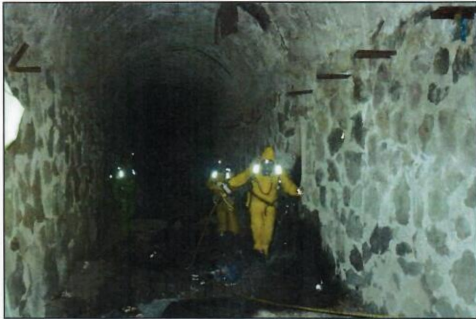
Fotografía 15. Socavación severa en cama de agua y paredes laterales (0+180).
