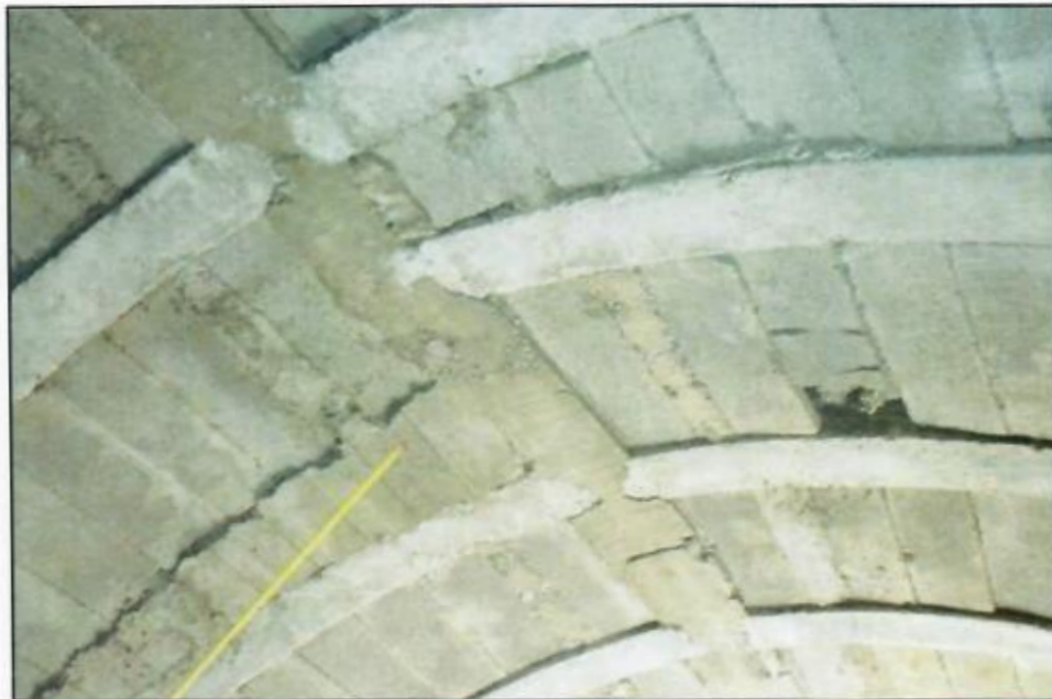
Fotografía 22. Vicios constructivos: evidencia de encofrado deficiente.
