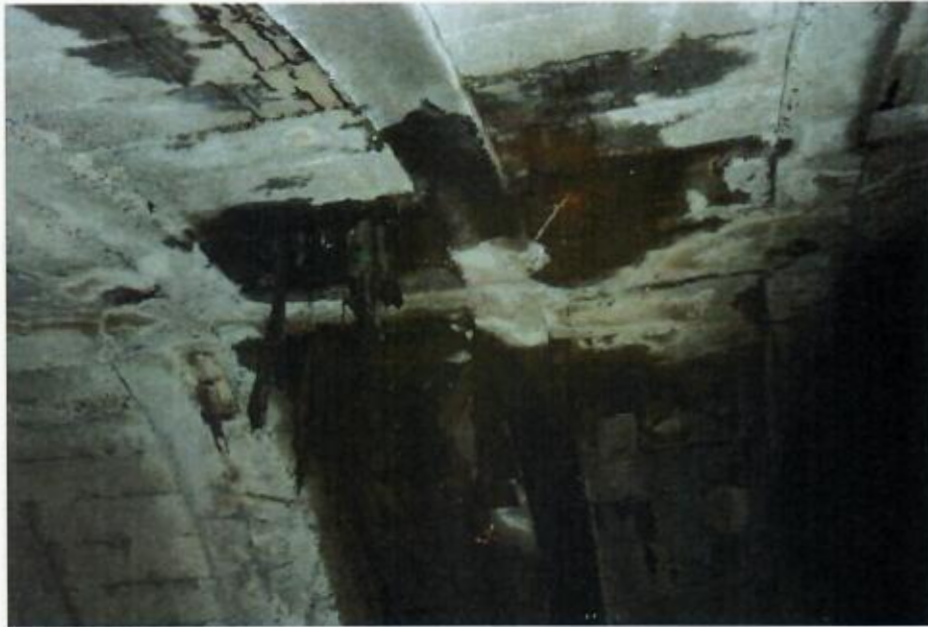
Fotografía 27. Infiltración en bovedilla y conexión de descarga en el arco de la bóveda (0+270).
