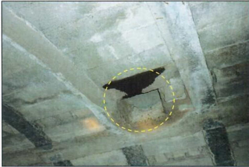
Fotografía 25. Infiltración en bovedilla y conexión de descarga en el arco de la bóveda (0+140).
