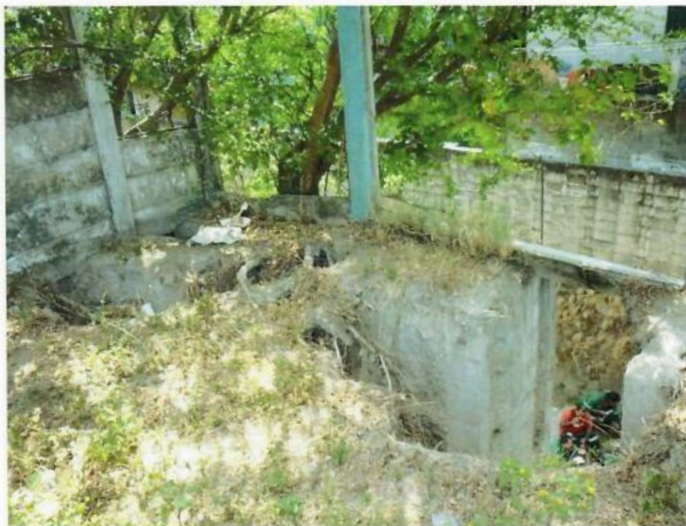
Fotografía 18. Continuación cárcava y muro expuesto.
