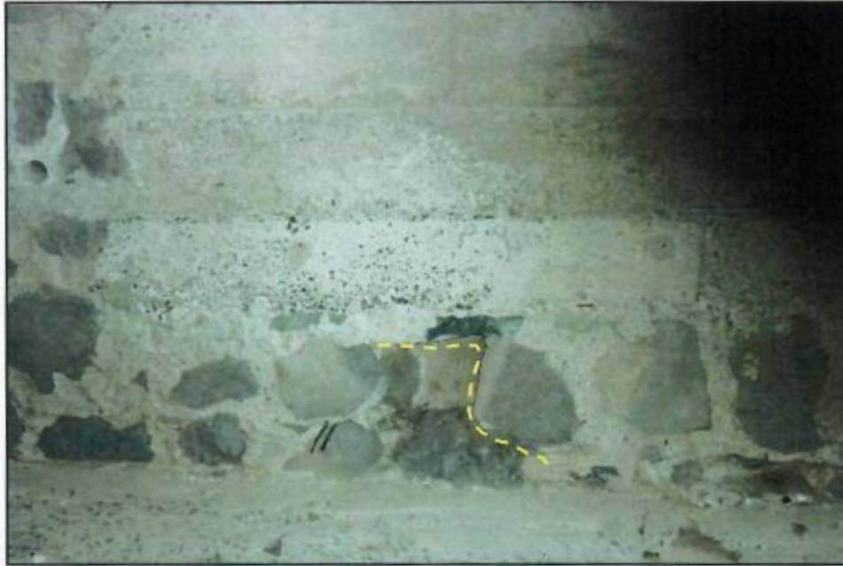
Fotografía 11. Agrietamiento en base de pared lateral (0+135).
