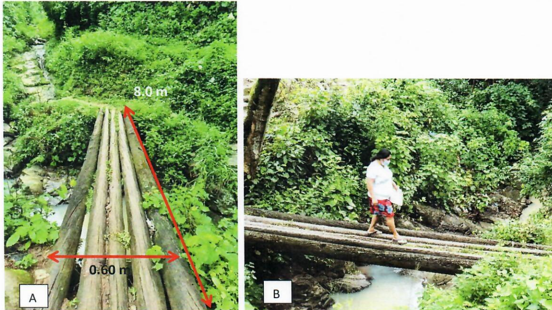
Fotografía N°2. Puente peatonal; A) Vista desde el puente; B) Vista hacia el puente desde aguas arriba de Quebrada S/N; nótese el riesgo que representa.
