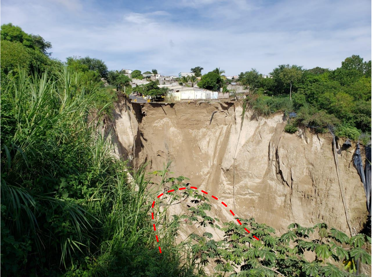
Fotografía 2. Vista del escarpe principal. 14/10/2019 Nótese material depositado bajo descarga de tubería de 60”.
