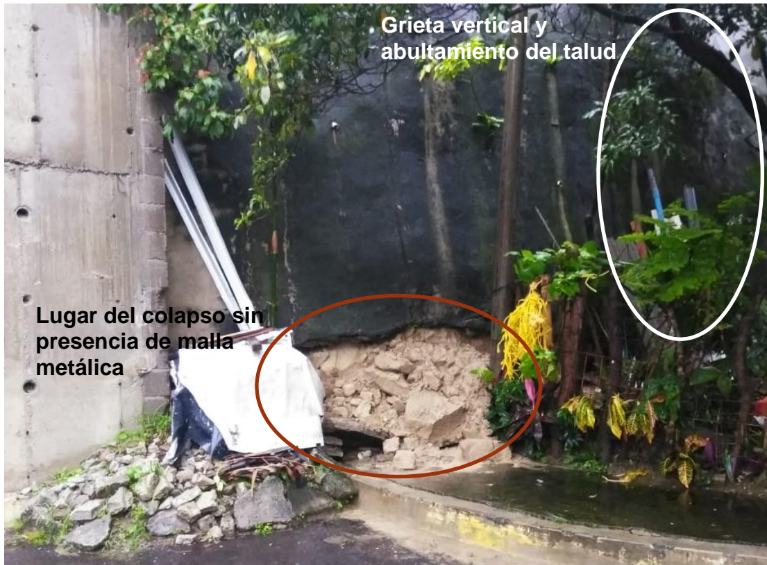
Fotografía N°2. Lugar del colapso al pie del talud
