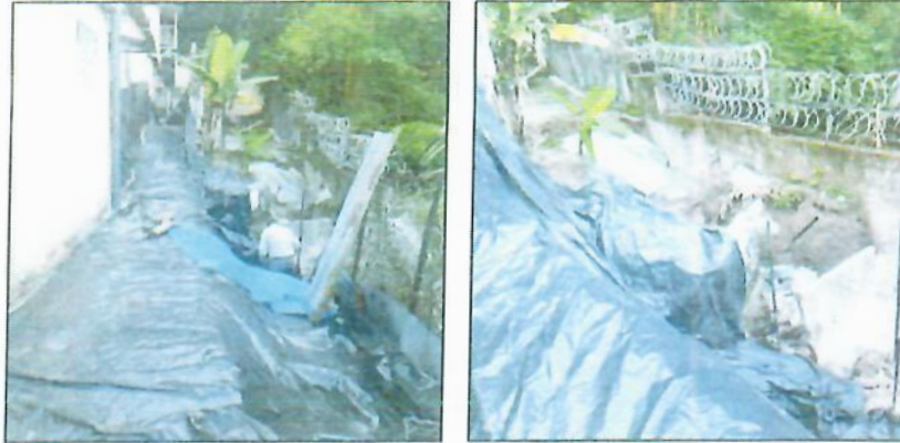
Fotografía N° 8. Protecciones temporales mediante membranas plásticas, que familiares del propietario han colocado sobre la porción expuesta, para evitar la prolongación de la socavación dentro de la propiedad.
