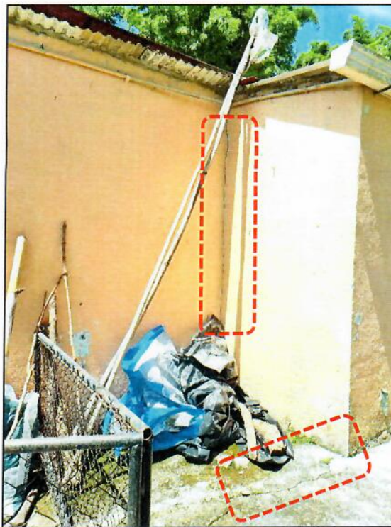
Fotografía N° 6. Presencia de grietas en paredes y pisos contiguos en área de pasillo, indicativo de la ocurrencia de asentamientos en los suelos próximos al muro de mampostería de piedra que colapsó.
