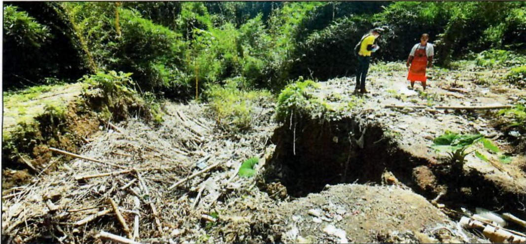
Fotografía N° 1. Área socavada en terreno baldío, al costado norte de la Urbanización Santa Úrsula, a la salida de canaleta de drenaje pluvial.
