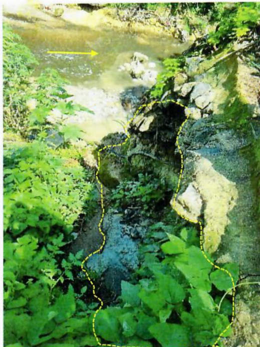
Fotografía N°5. Socavación en muro sobre margen derecha del Río Urbina, a 1.50 m de punto de descarga.
