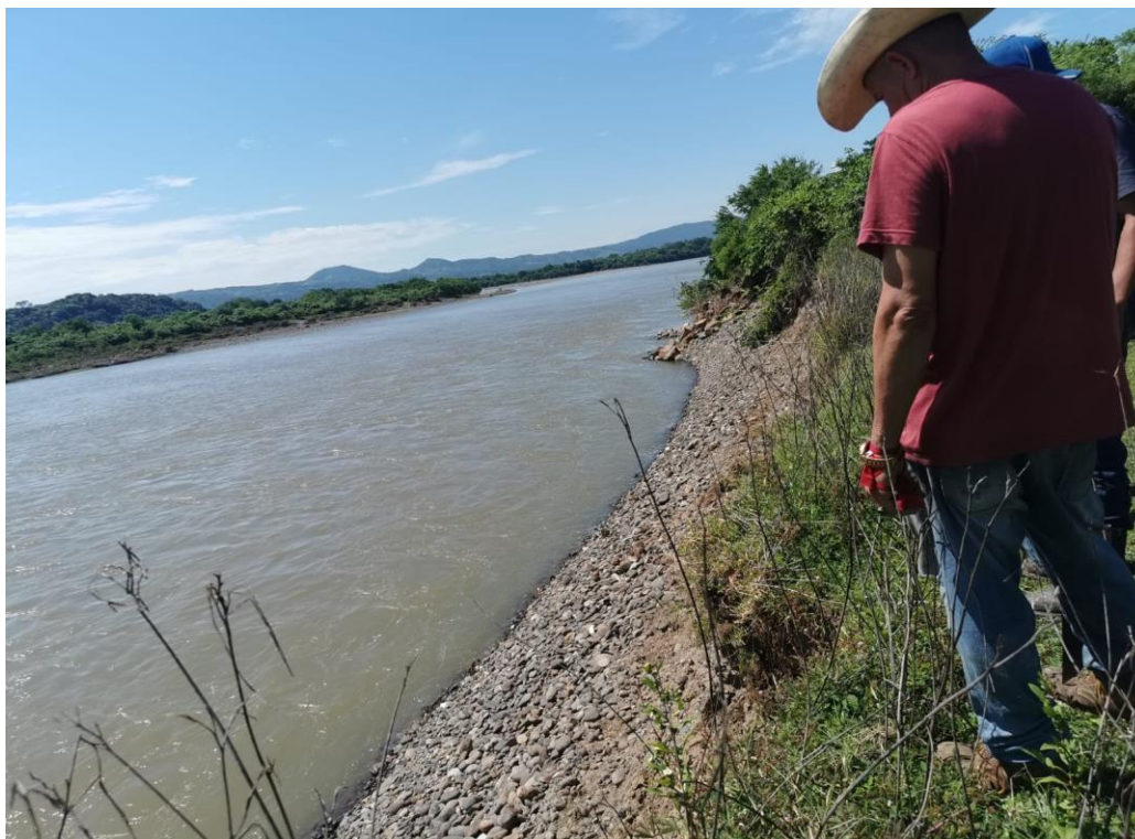
Fotografía No.2 Márgenes erosionados de Río Lempa
