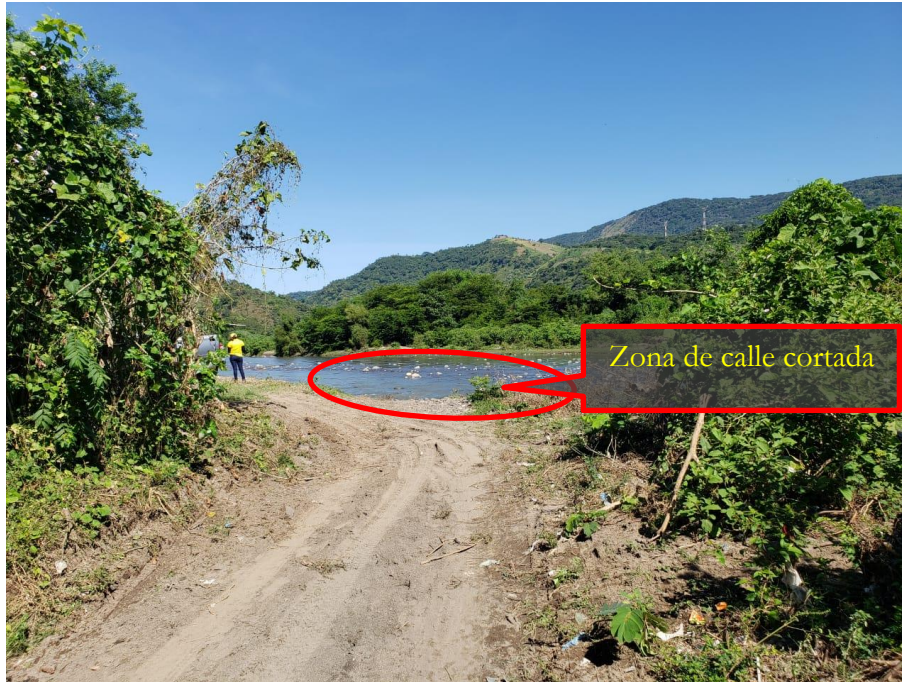
Fotografía 1. Camino vecinal para conectar Caseríos Guarumo con Casas Viejas; obsérvese giro abrupto a 90° por corte de calle producto de la erosión del Río
