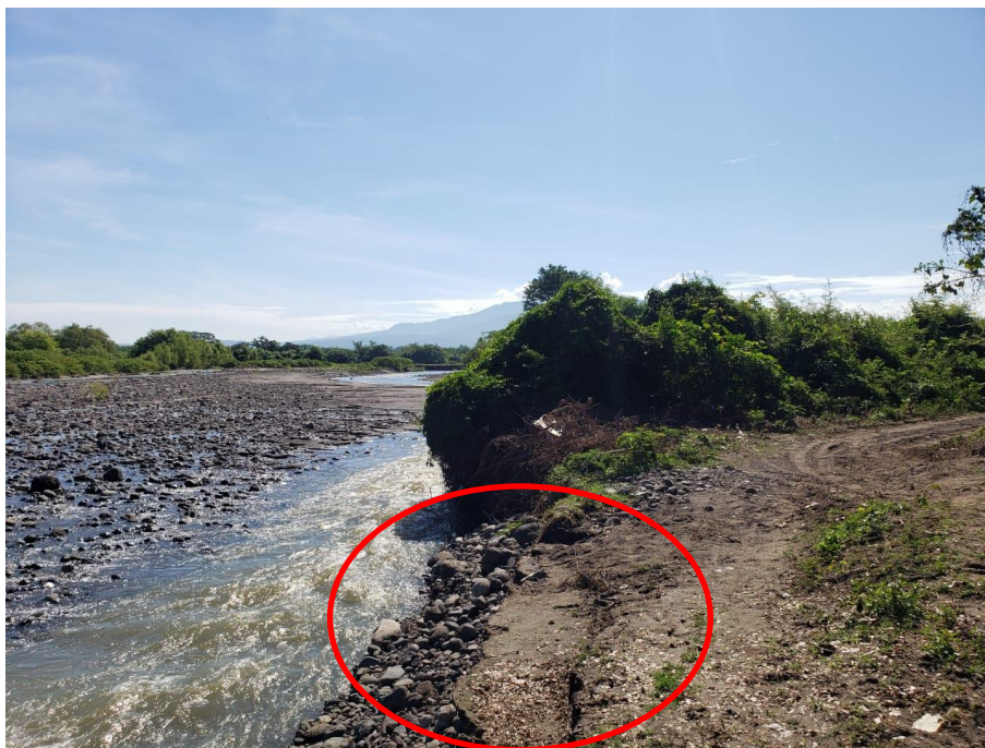
Fotografía 3. Flujo de Río tendido hacia margen derecho, erosionando margen; en círculo, zona de calle cortada
