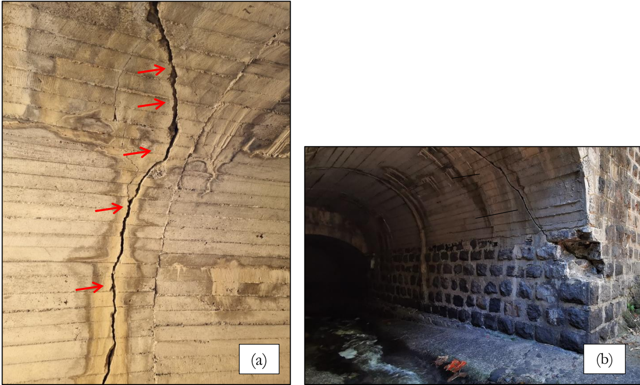
Fotografía N° 2. Agrietamiento en parte superior de primer tramo de bóveda recorrido, en a) parte superior izquierda, b) parte superior derecha.
