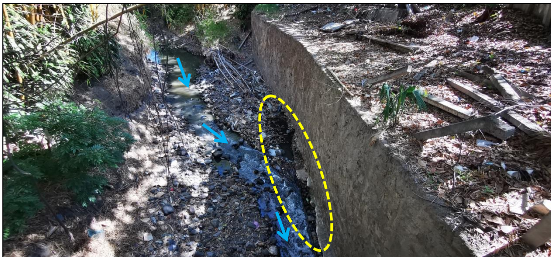
Fotografía N° 8. Daños detectados por socavación en base de un muro de protección, en margen izquierda de Quebrada La Mascota, a 50.00 metros aguas arriba de entrada de bóveda.
