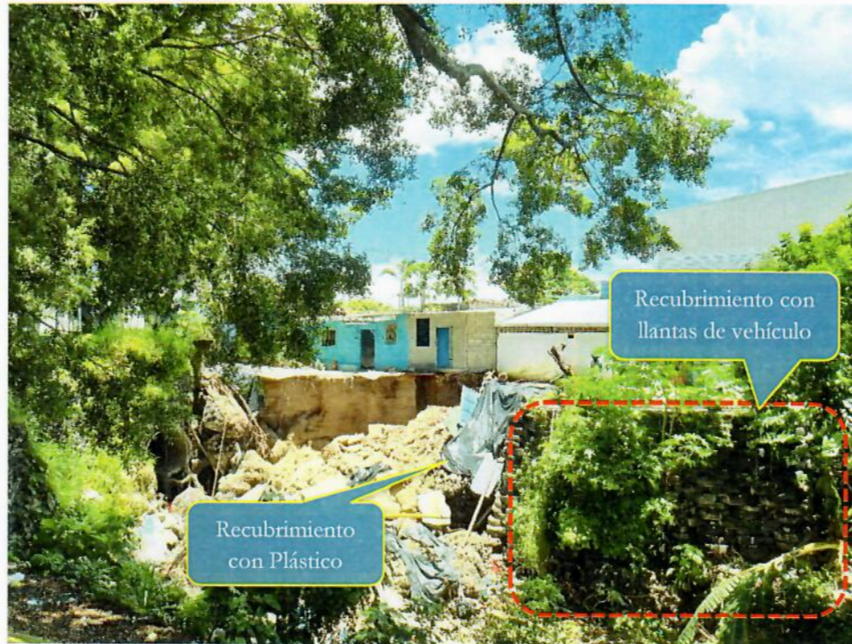
Fotografía N°4. Recubrimiento de talud con plástico y llantas de vehículo
