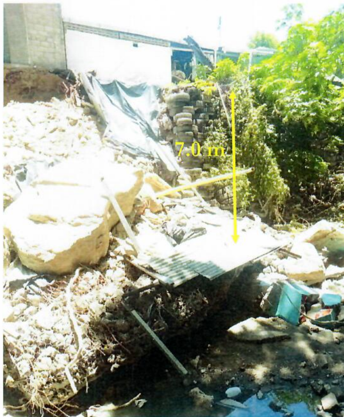
Fotografía N°2. Altura del muro gavión colapsado.
