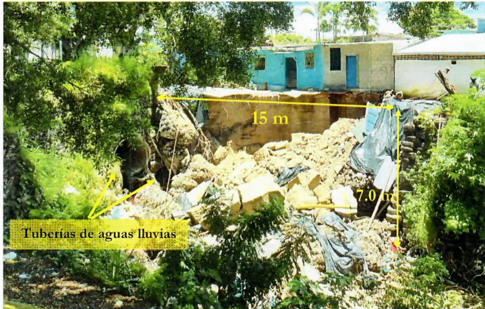
Fotografía N°1. Lugar de inspección, colapso de muros gavión sobre margen izquierda de Quebrada.
