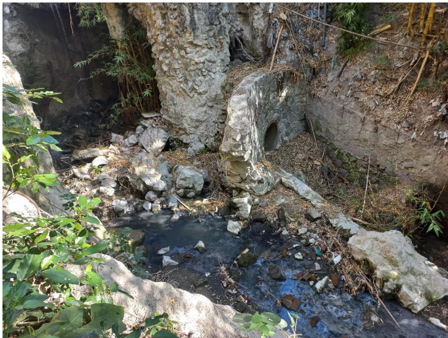
Fotografía 3. Colapso de Muro de mampostería para protección y cabezal de descarga; obsérvese estructura de Pozo expuesta; febrero 2023
