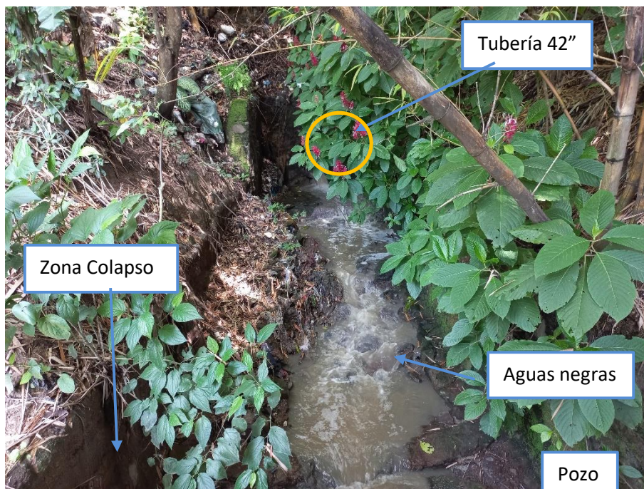
Fotografía 1 Canal abierto donde descarga Sistema de Aguas lluvias de la zona, actualmente flujo causante de erosión es Aguas Negras desviada por ANDA mientras se realizan trabajos temporales en su red del sector
