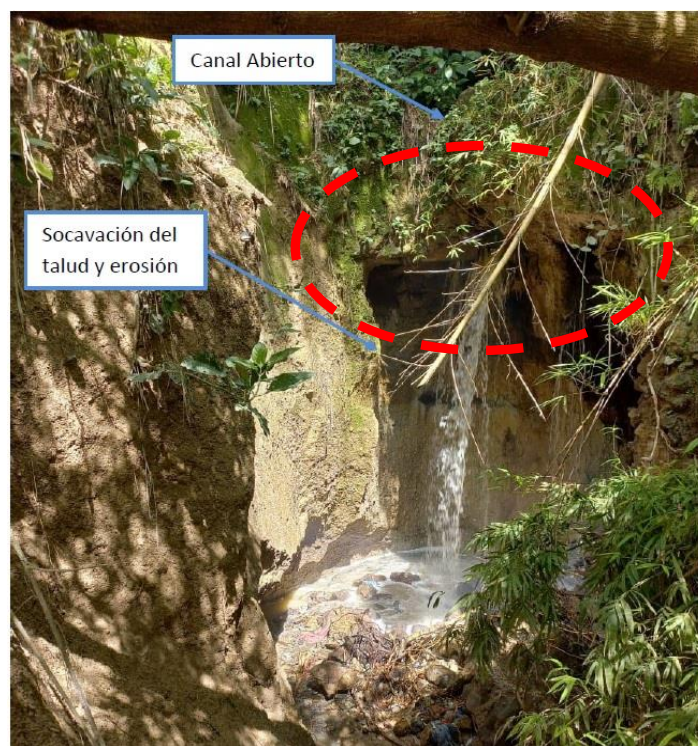
Fotografía 2. Estado de cárcava en 2021; obsérvese enmarcado, zona colapsada actualmente. Tomado de Informe Ref. VMOP-DACGER-075-2021.
