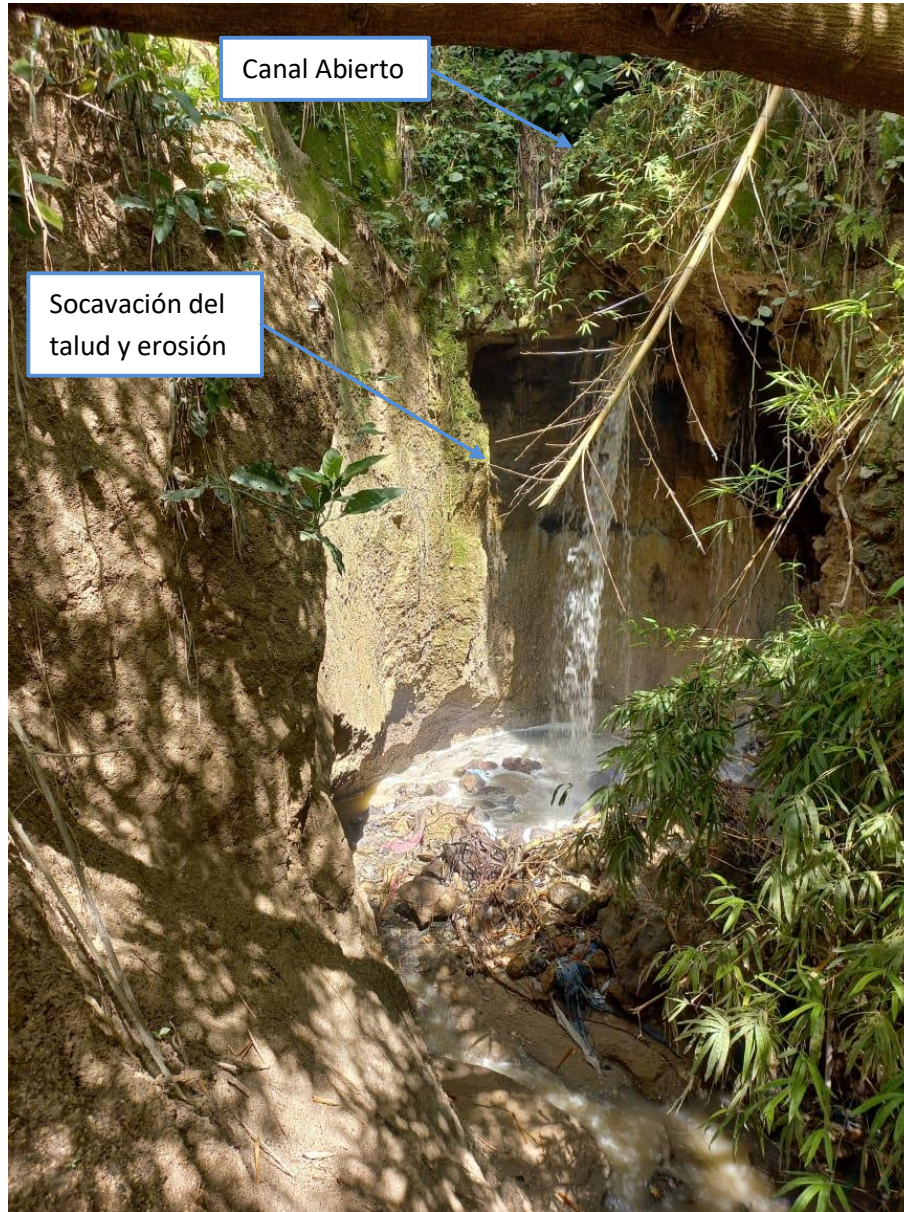
Fotografía 3. Erosión por debajo de Canal Abierto debido al flujo constante de Aguas Negras
