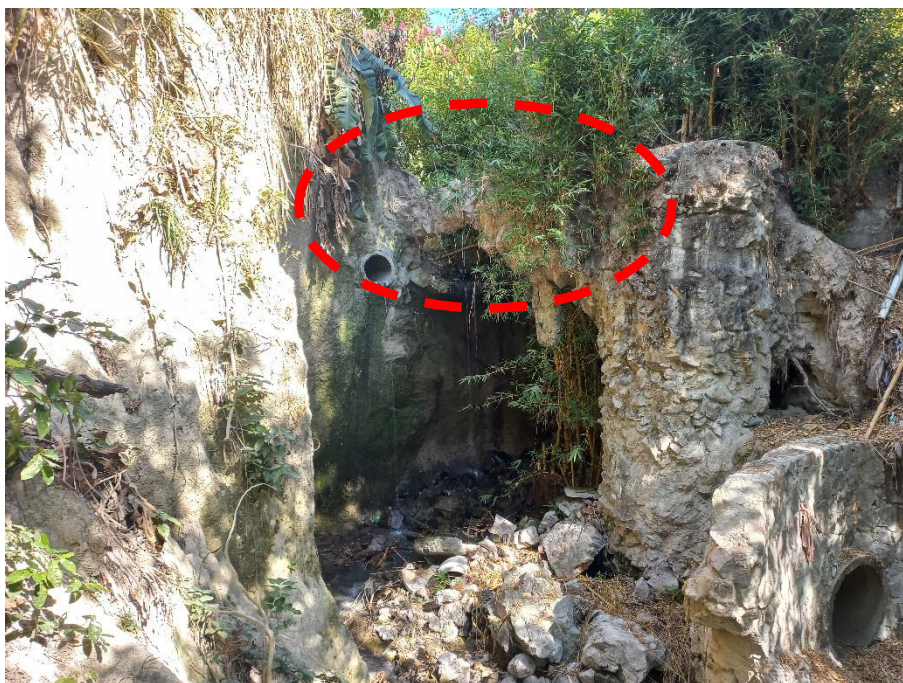
Fotografía 4. Zona de colapso de Canaleta
