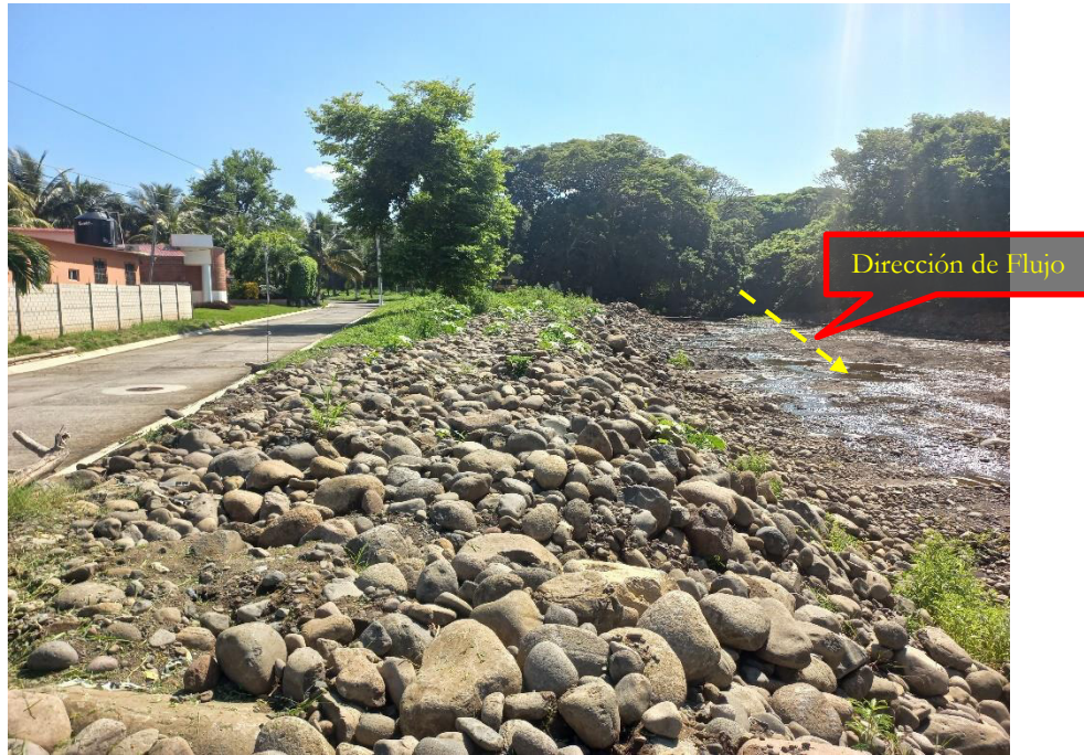
Fotografía N° 3. Zona de colapso de Borda; punto de desbordamiento de Río, material visible en fotografía, es material volcado en tareas de limpieza del cauce realizado por el MOPT
