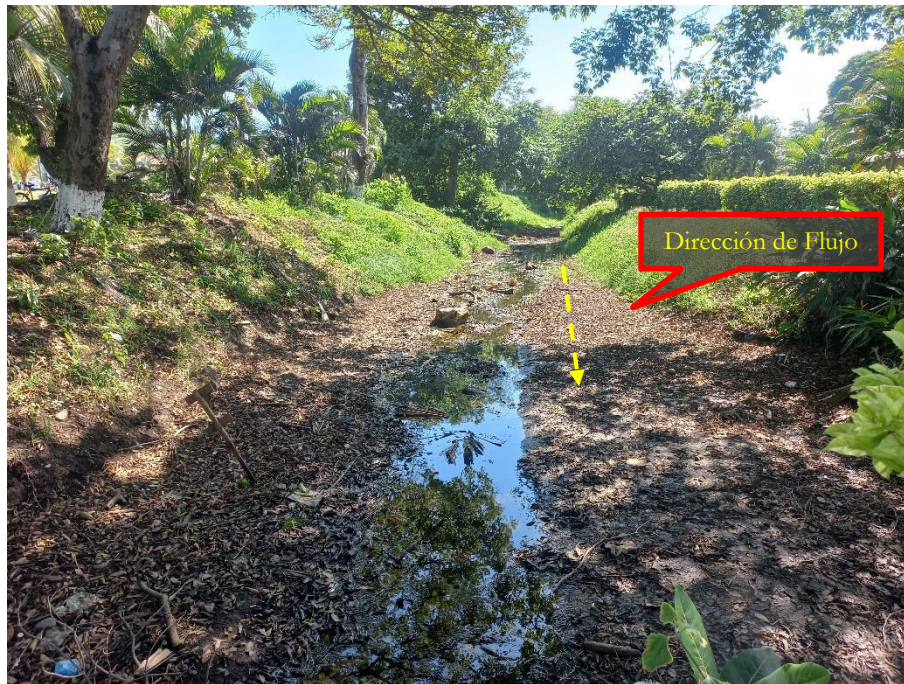
Fotografía N° 5. Cauce de Canal secundario donde el agua se desvía e inunda Casa Club; canal pertenece a antiguo cauce del Río, según cartografía.
