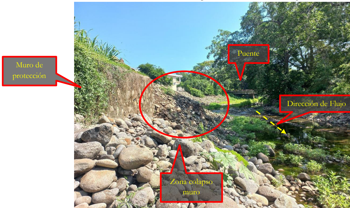
Fotografía N° 4. Zona de colapso de muro de protección en margen derecho de Río, aguas abajo de Puente sobre la CA-02
