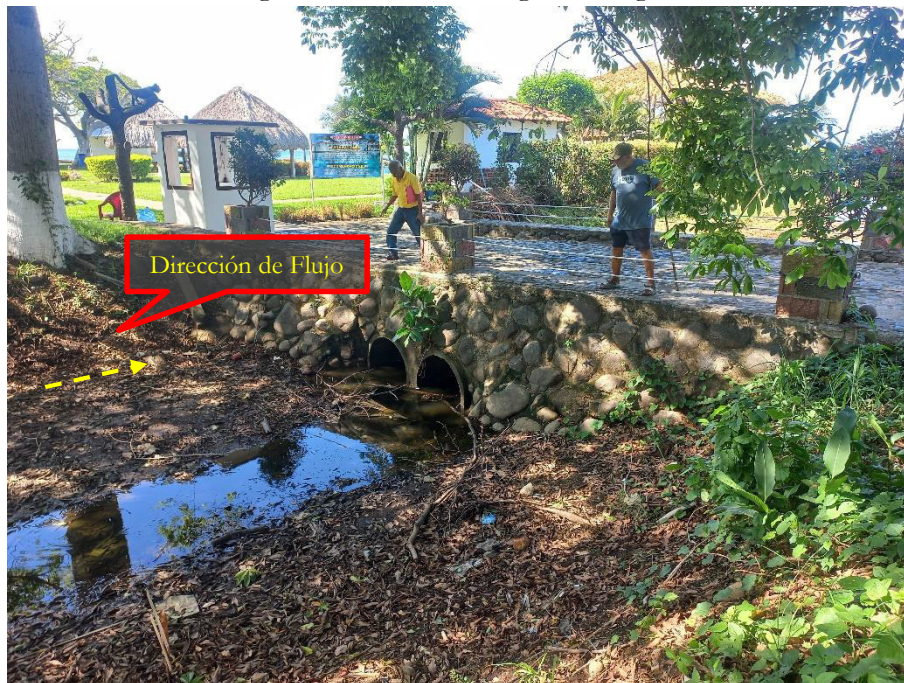
Fotografía N° 6. Obra de paso existente sobre canal secundario para pasar de solo residencial a Casa Club (zona desbordamiento de Río)
