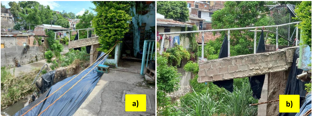
Fotografía N°3. a) Vista de viviendas afectadas, b) pasarela colapsada
