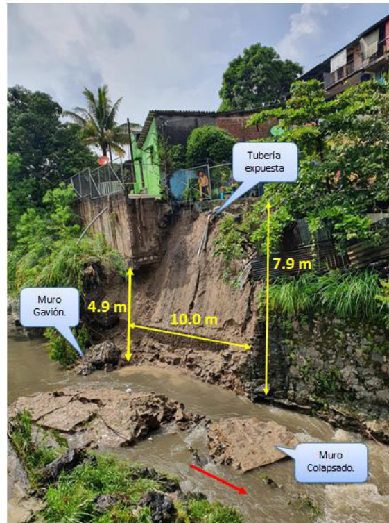
Fotografía N°1. Muro colapsado sobre margen izquierda del Arenal Tutunichapa, y talud expuesto. Foto de archivo Informe REF. VMOP-DACGER-059-2022
