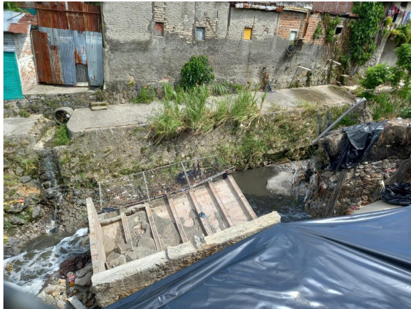
Fotografía N°2. Colapso de muro de mampostería de concreto
