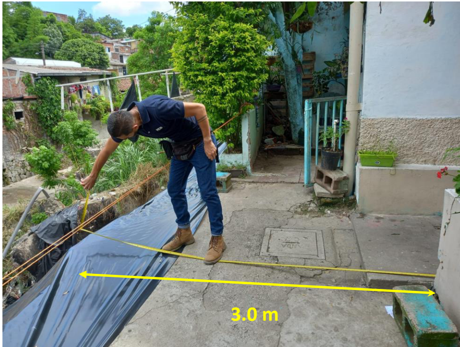
Fotografía N°4. Distancia entre corona del talud y acceso a vivienda
