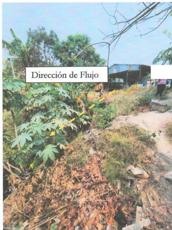
Fotografía 1. Formación de Cárcava por inadecuada canalización de flujo de escorrentía y falta de obras de protección.
