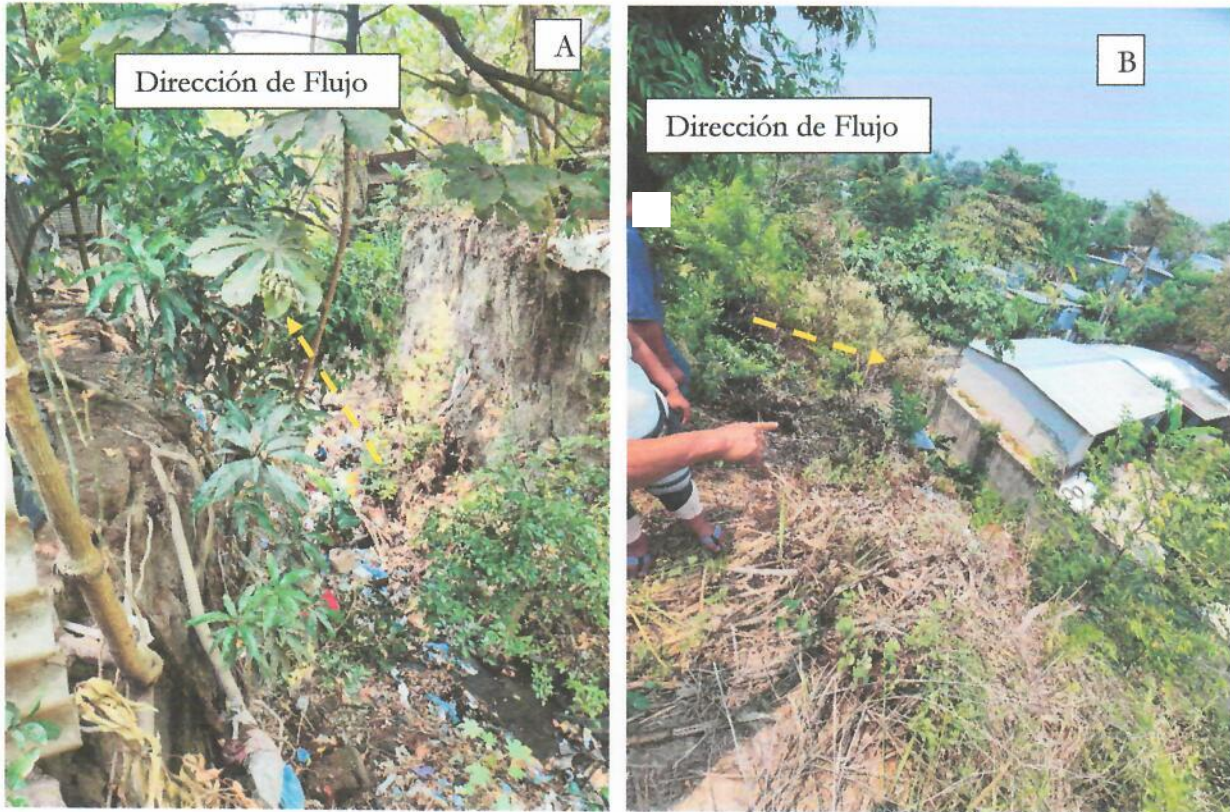
Fotografía 9. a) Canalización generada por escorrentía superficial b) probable zona de falla por deslizamiento y aumento de dimensiones de cárcava.
