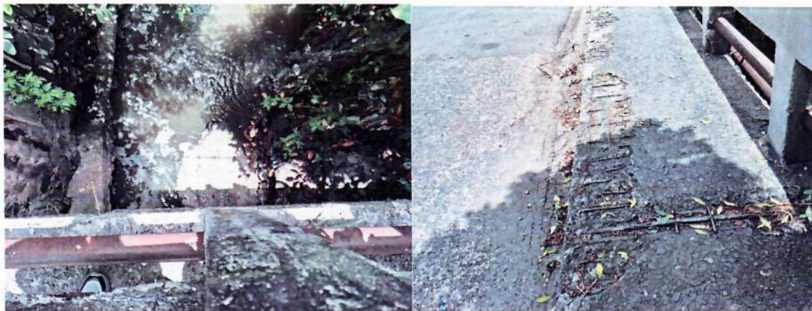
Imagen 10. Daños observados en Puente sobre Av. 29 de agosto
