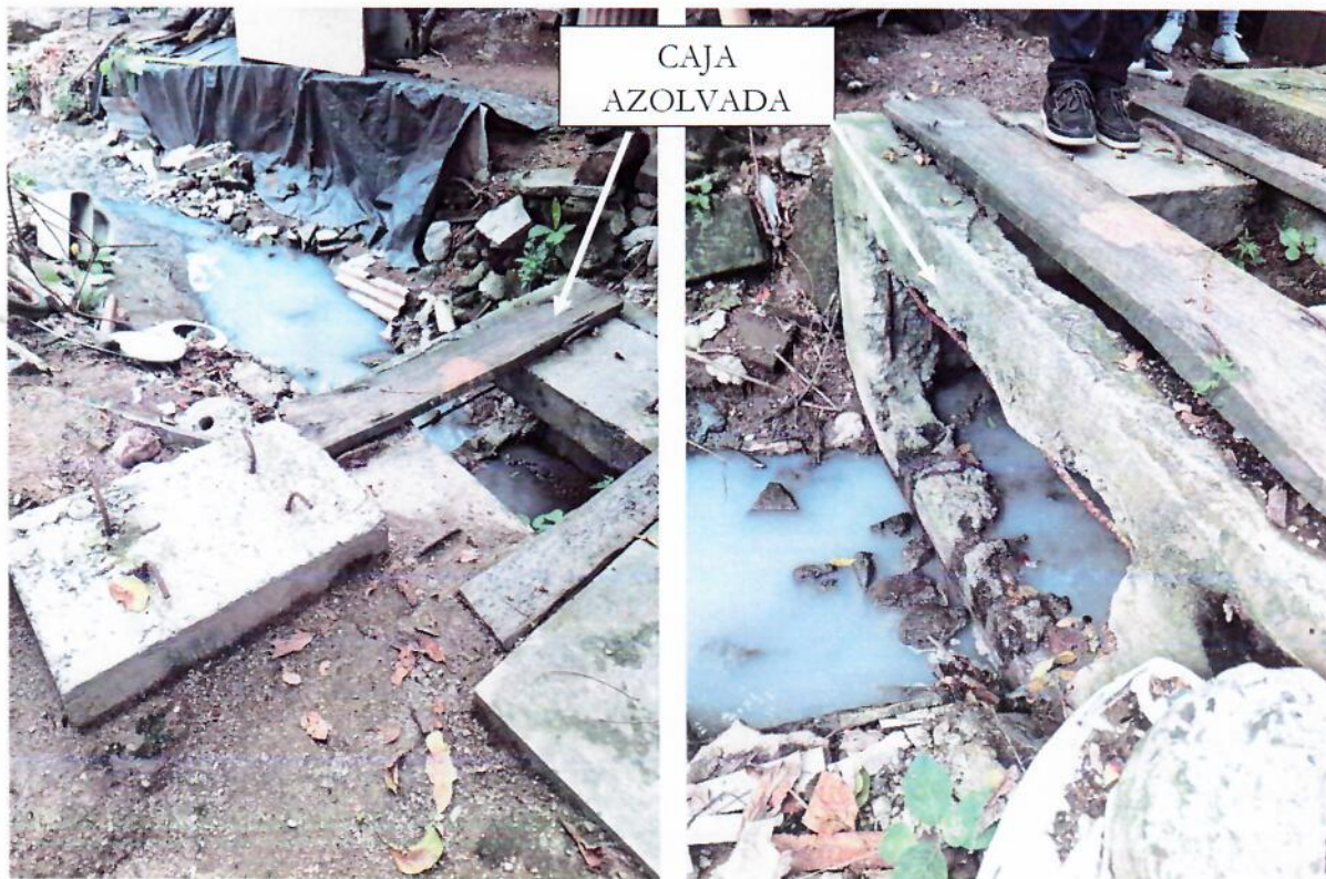
Imagen 17. Caja azolvada la cual rompieron los habitantes para dejar salir el agua.
