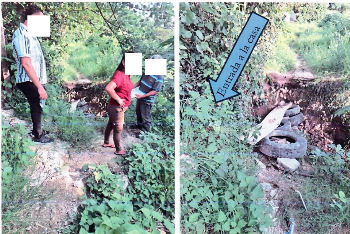
Imagen 16. Punto 9. Cárcava que afecta el paso y el ingreso a la vivienda
