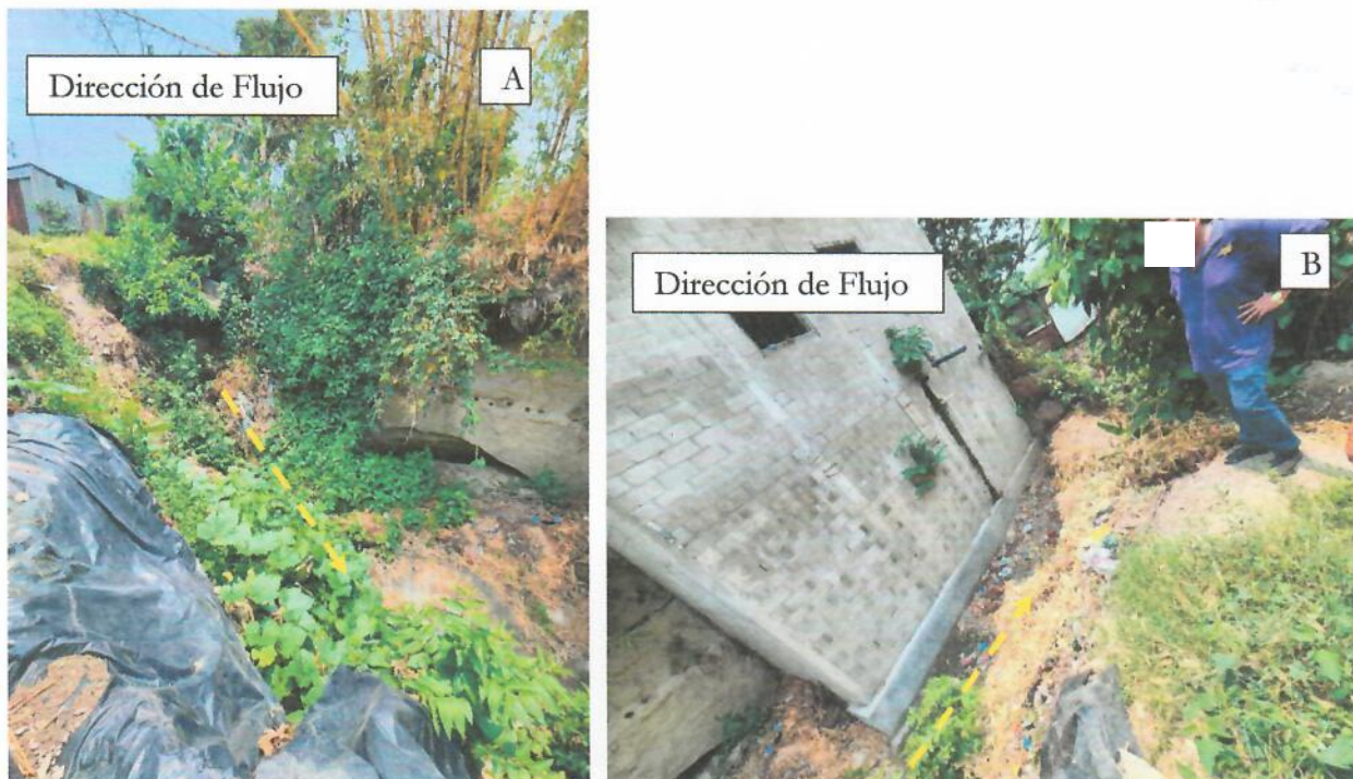
Fotografía 8. a) Escorrentía Superficial erosionando por acumulación de flujo b) Edificación obstruyendo el libre paso de vaguada
