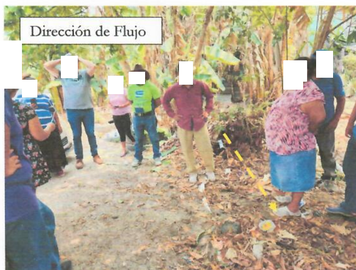
Fotografía 5. Tareas de limpieza para evitar obstrucciones en el drenaje de la zona.
