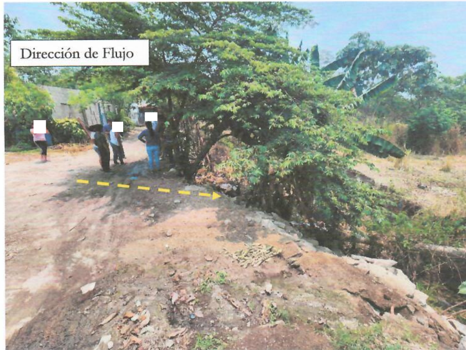
Fotografía 6. Relleno con ripio, tierra, escombros entre otros.
