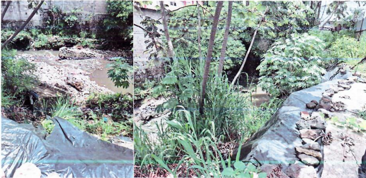
Imagen 11. Vivienda con problemas de erosión en talud por Quebrada La Mascota.
