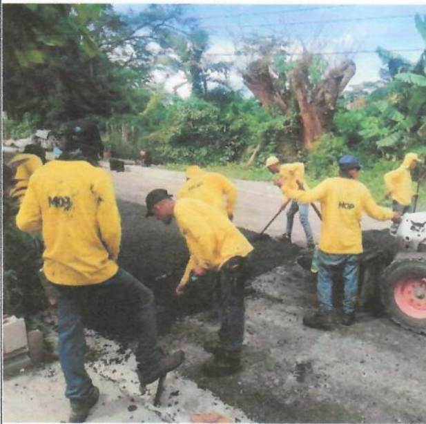
Personal de DISA colocando mezcla asfáltica donde fue acopiada la piedra en pasaje Los Cinco.
