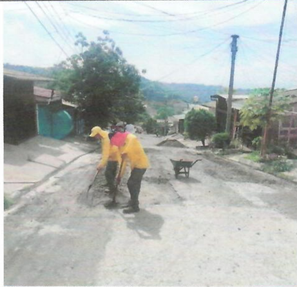
Del jueves 6 hasta el día martes 11 de julio, equipo de la constructora realizó obras de bacheo y colocación de asfalto, como parte de las obras compensatorias.
