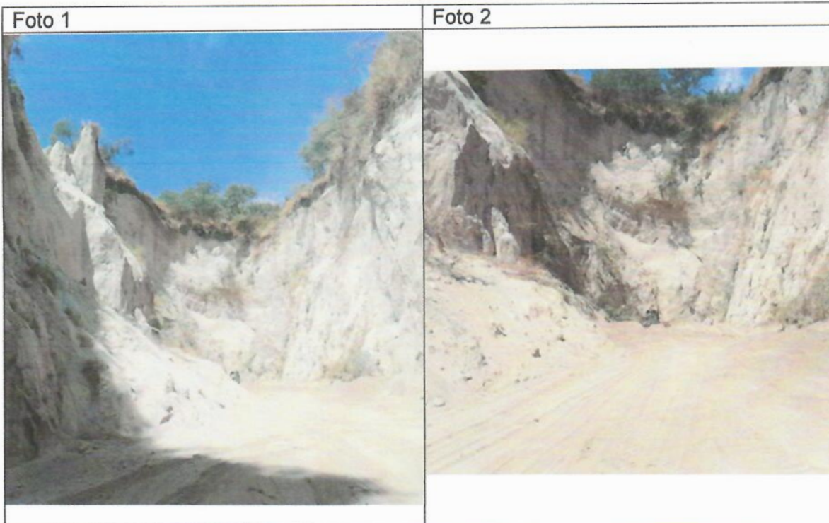
Fotografía de cárcava existente antes de la intervención de las obras complementarias.
