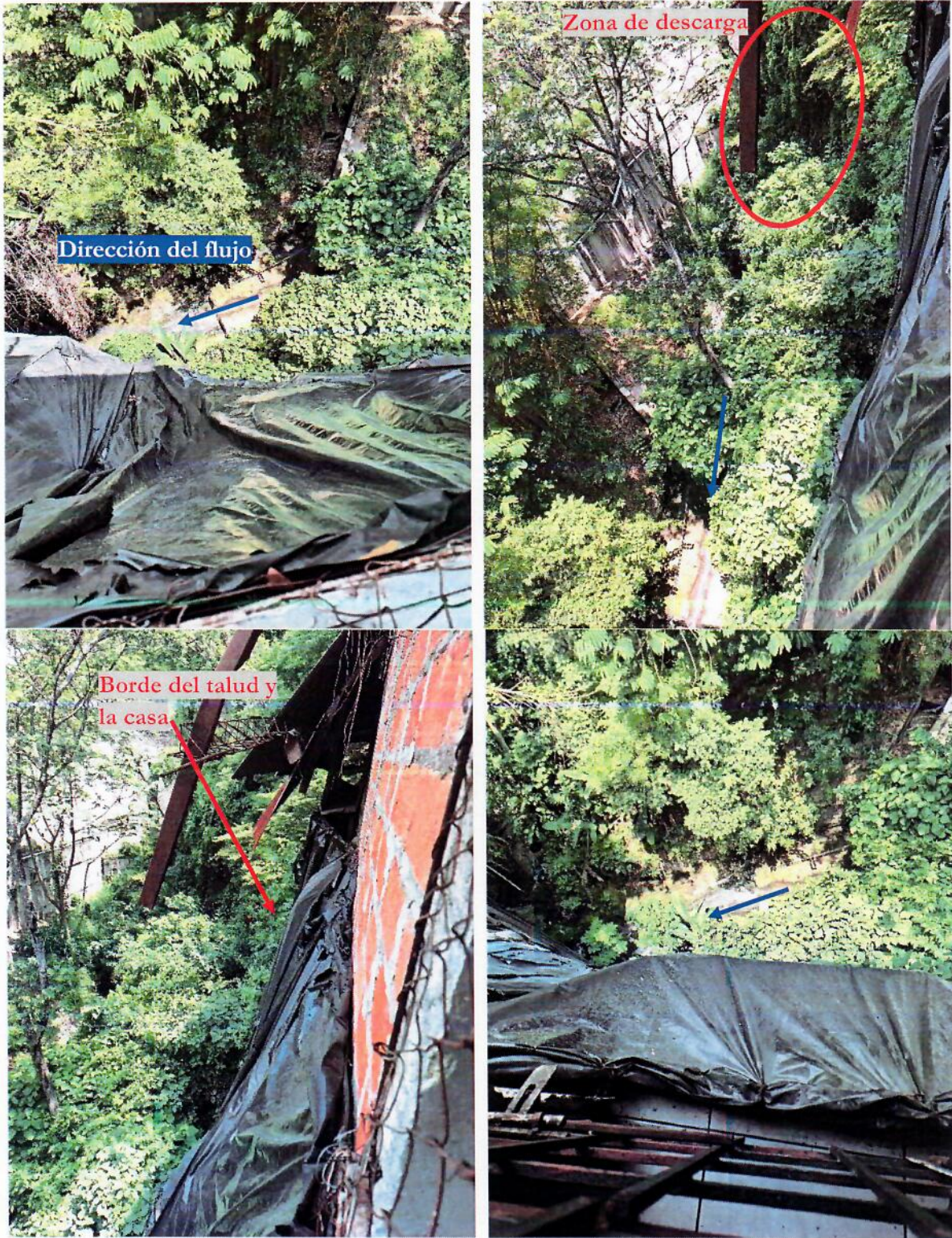
Imagen 3. Vista de la casa 9 y borde del talud
