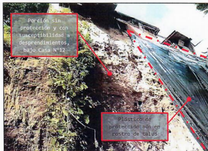
Fotografía N° 2. Vista desde el pie del talud y plástico colocado para evitar erosión. Fotografía provista por propietario.
