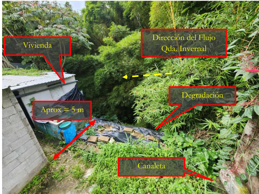
Fotografía N° 3 Vista panorámica Quebrada Invernal y Vivienda en riesgo)
