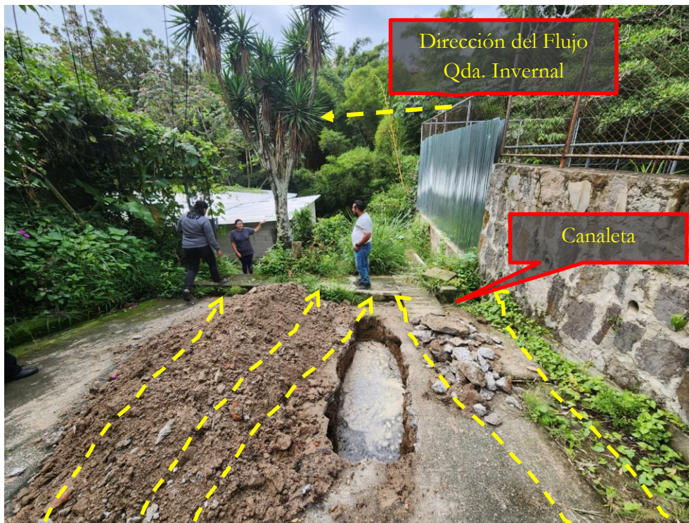
Fotografía N° 6. Líneas de escurrimiento superficial y trabajos inconclusos de ANDA.
