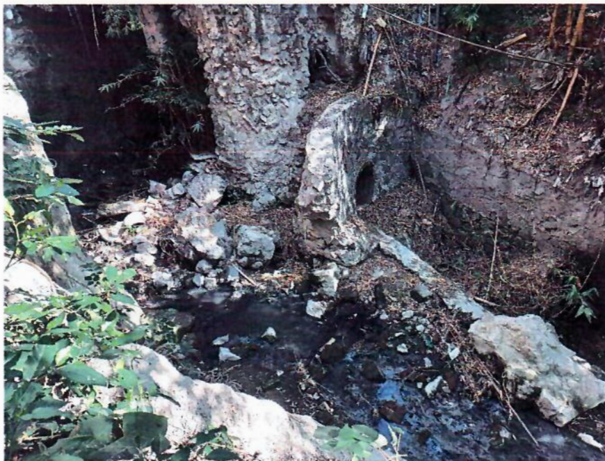
Fotografía 3. Colapso de Muro de mampostería para protección y cabezal de descarga; obsérvese estructura de Pozo expuesta; febrero 2023
