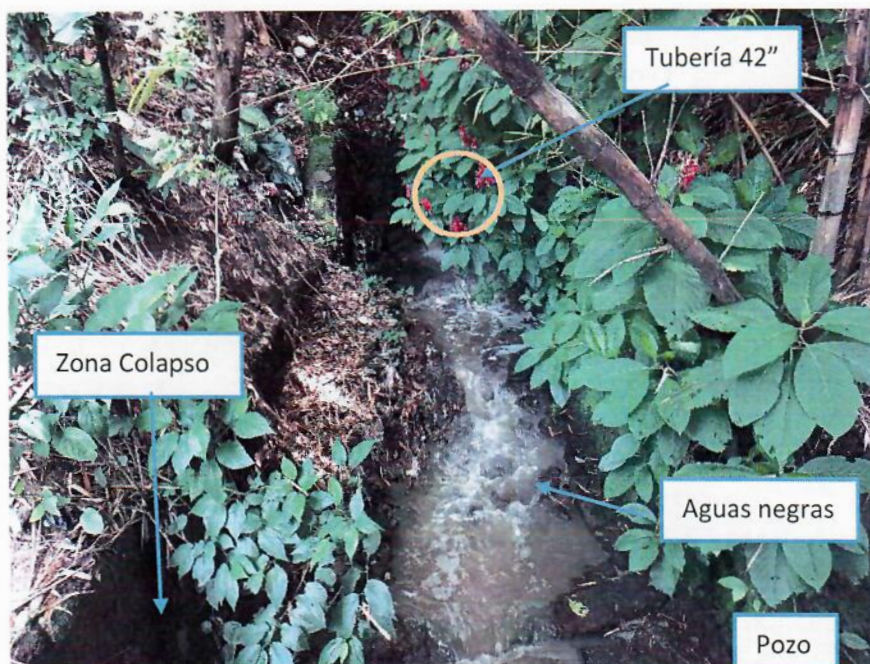
Fotografía 1 Canal abierto donde descarga Sistema de Aguas lluvias de la zona, actualmente flujo causante de erosión es Aguas Negras desviada por ANDA mientras se realizan trabajos temporales en su red del sector
