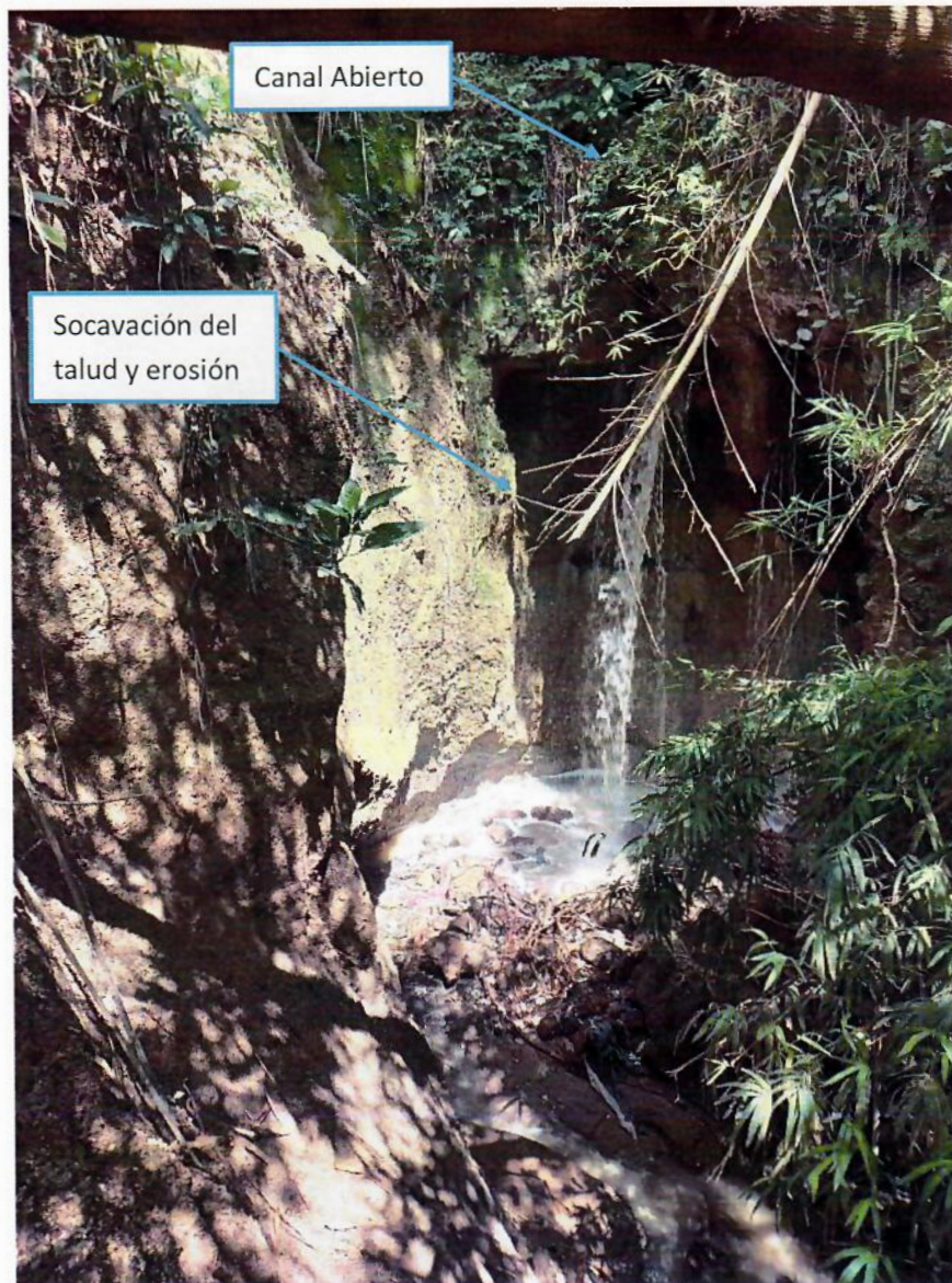
Fotografía 3. Erosión por debajo de Canal Abierto debido al flujo constante de Aguas Negras
