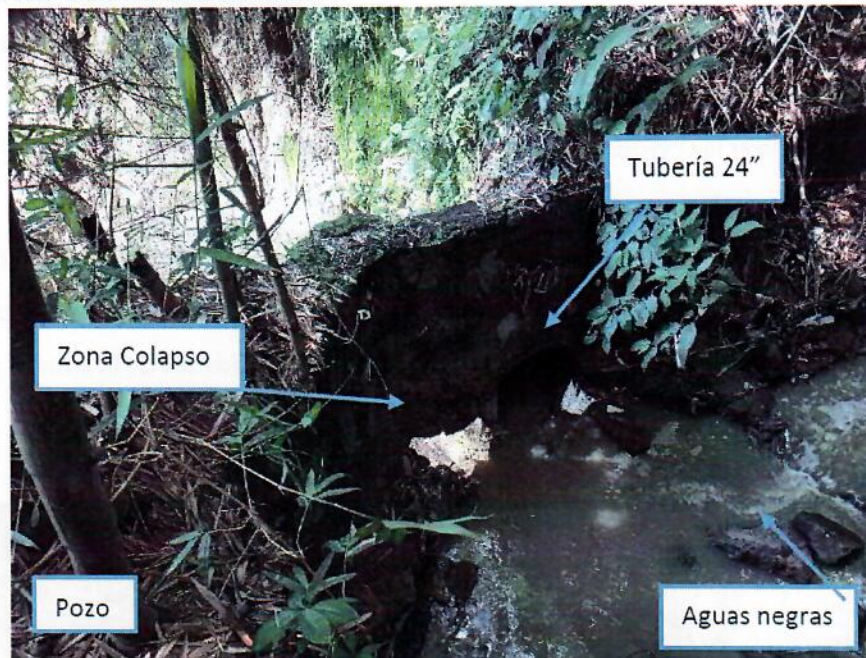
Fotografía 1. Vista de parte alta de canaleta donde se estaba filtrando el agua hacia talud natural (zona actualmente colapsada) Tomado de Informe Ref. VMOP-DACGER-075-2021.
