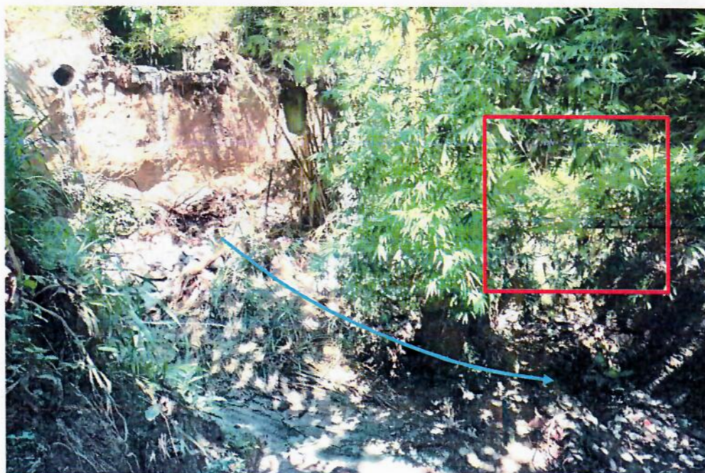
Figura 2. Situación de febrero de 2023 (arriba) y de noviembre de 2023 (abajo). Nótese colapso en borde izquierdo.
