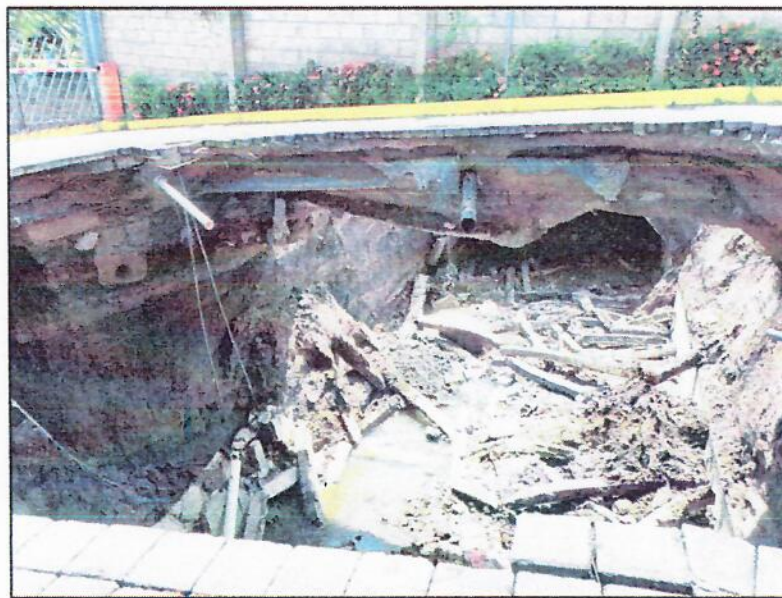
Fotografía N° 2. Arrastre de escombros de colapso debido a evento hidrometeorológico del 14 de agosto.
