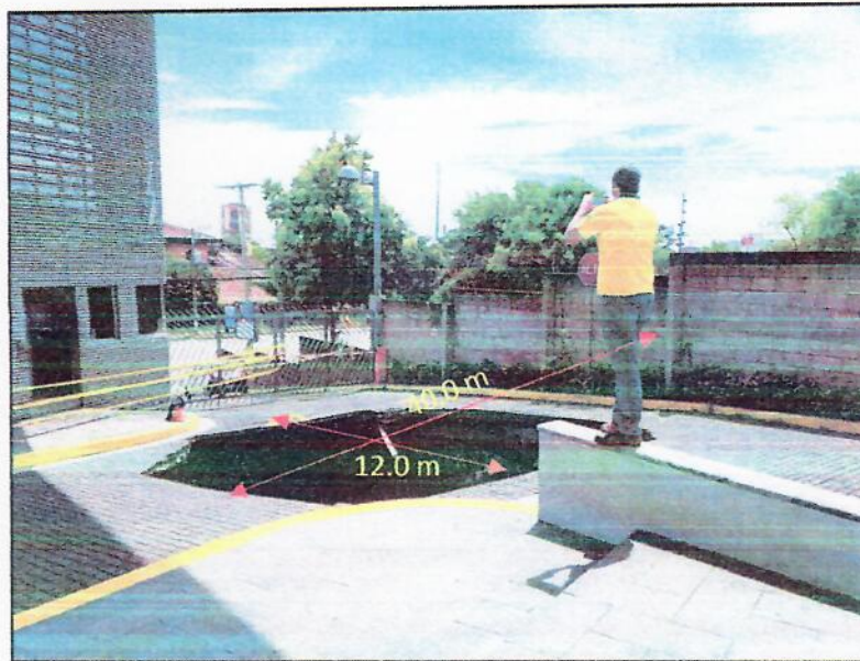
Fotografía N° 1. Oquedad formada en calle de acceso interno de Edificio Bicentenario de RSM producto de la ampliación Colapso de tramo de Bóveda sobre Quebrada El Piro.
