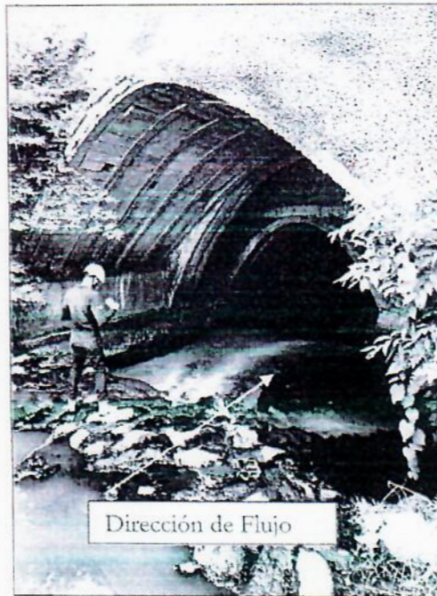
Fotografía 1. Ingreso a Bóveda Quebrada El Piro sector Edificio de Red Salvadoreña de Medios.
