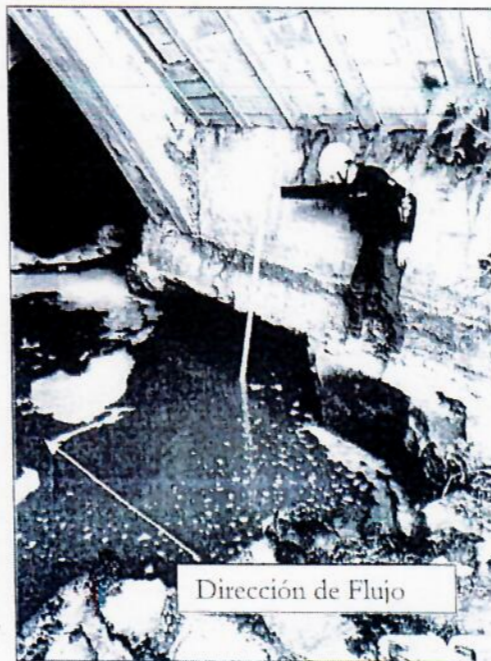
Fotografía 2. Socavación de cama hidráulica y muros de soporte. H = 1.0 m. aprox.
