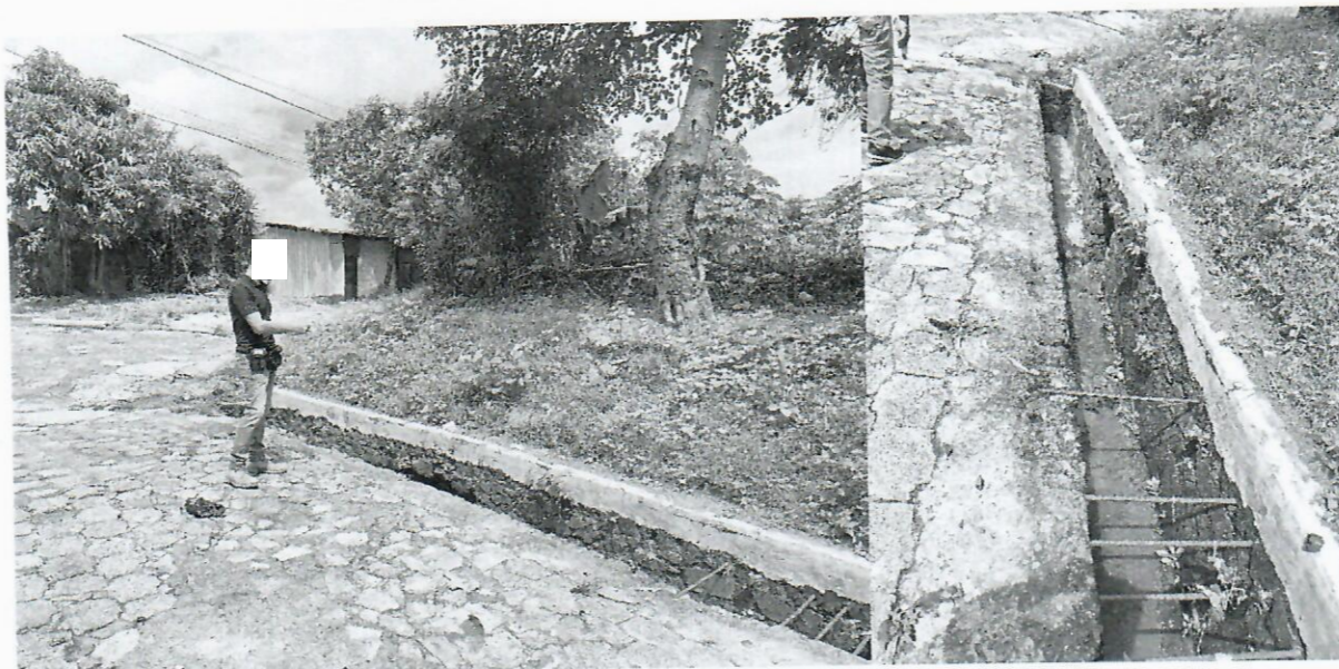
Imagen 3. Estado actual de la canaleta al final del pasaje
