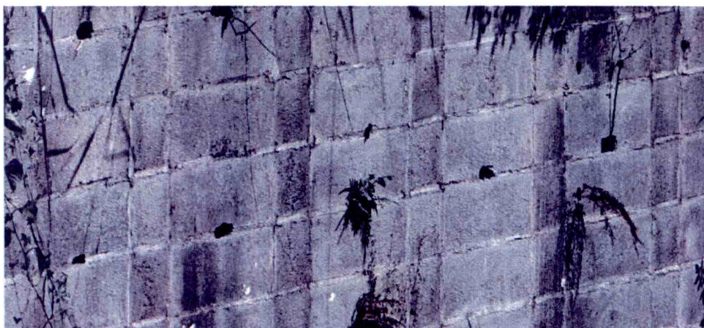
Fotografía N° 9. Ubicación y distribución de agujeros observados en rostro externo de las porciones de muro de mampostería de bloque de concreto.
