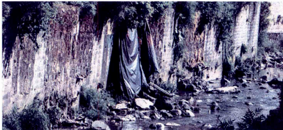
Fotografía N° 4. Vista hacia porción de muro colapsado, margen izquierda de Arenal Tutunichapa, en el sitio donde se ha producido la socavación a un costado de la Calle El Ciró.
