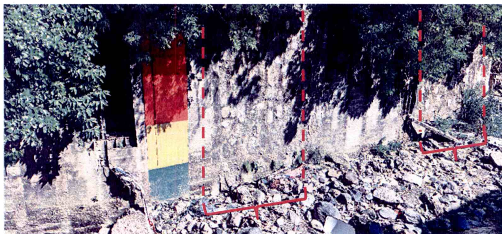
Fotografía N° 8. Vista típica hacia porciones de muro elaborados en mampostería de piedra en muro inspeccionado.
