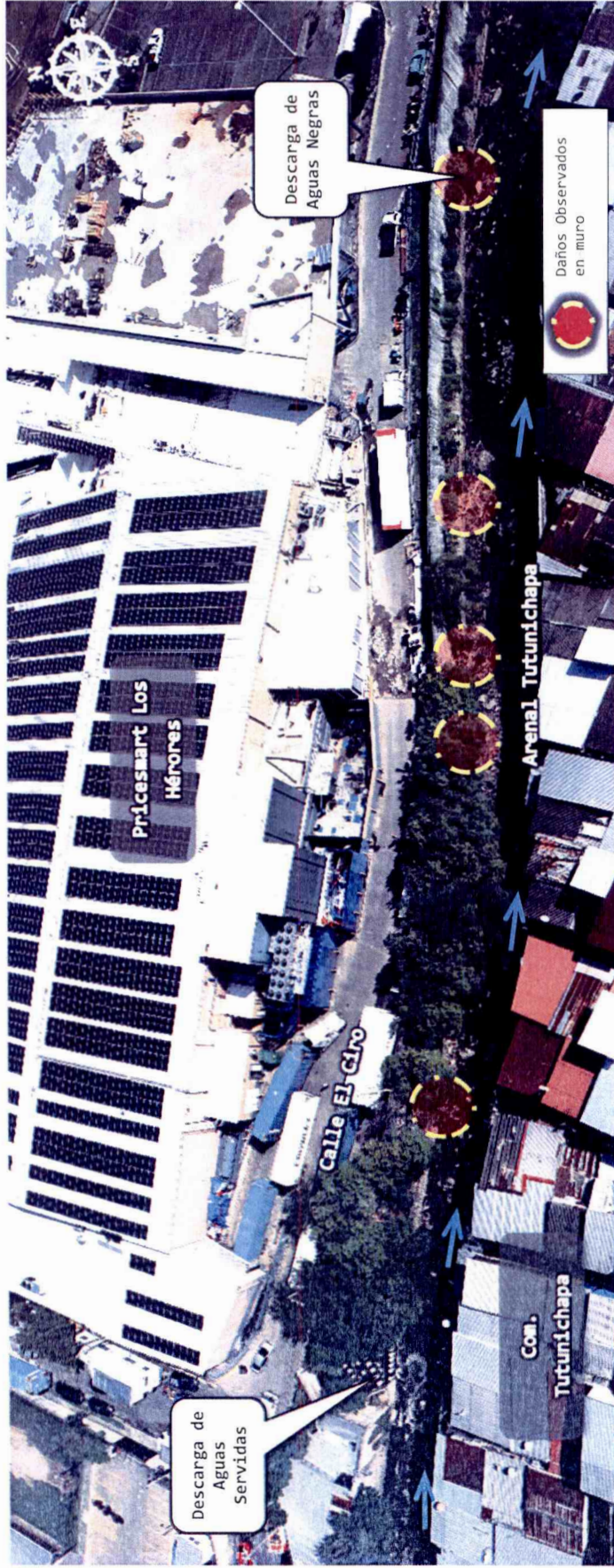
Fotografía N° 7. Vista general de ubicación de daños observados a lo largo de un tramo de protección en margen izquierda del Arenal Tutunichapa, contiguo a costado sur de "Prícesmart Los Hérores", con fotografía aérea el día de la inspección. Nótese presencia y paso de vehículos y camiones de carga sobre la corona del talud protegido por el muro dañado.
