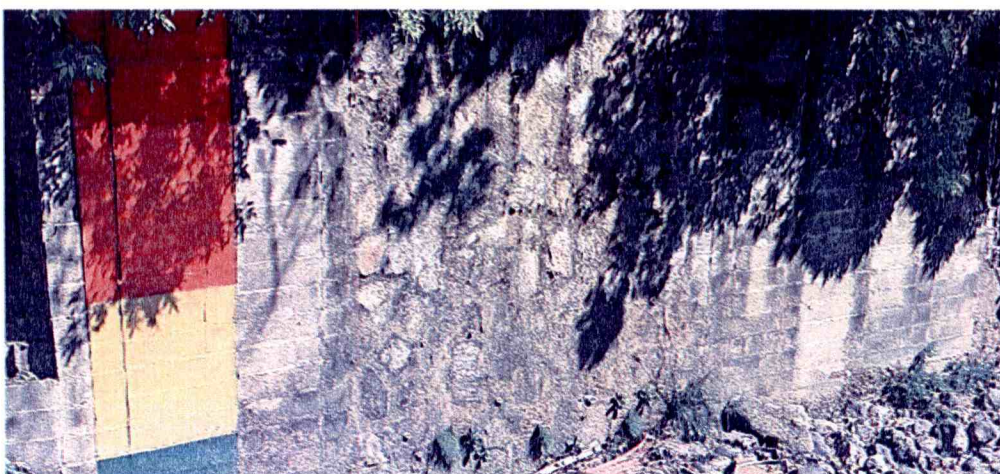
Fotografía N° 10. Ubicación y distribución de agujeros (barbacanas) en rostro externo de porciones de muro de mampostería de piedra.
