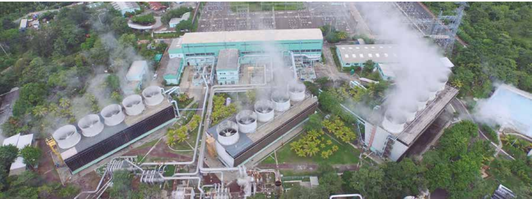
Central Geotérmica Ahuchapán
