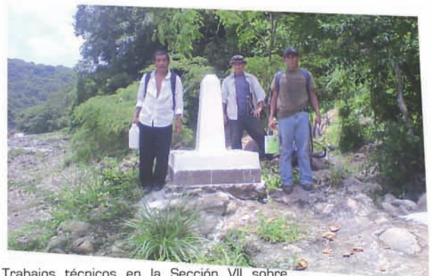
Trabajos técnicos en la Sección VII sobre el Río Goascorán, Concepción de Oriente y Pasaquina, La Unión
