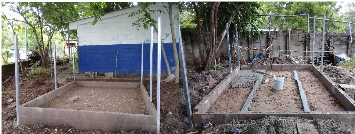
Estacion de desechos solidos C.E. San Isidro Estacion de desechos solidos C.E. San Isidro
