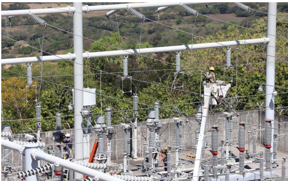
Personal de ETESAL realizando obras de mantenimiento a la red de transmisión
