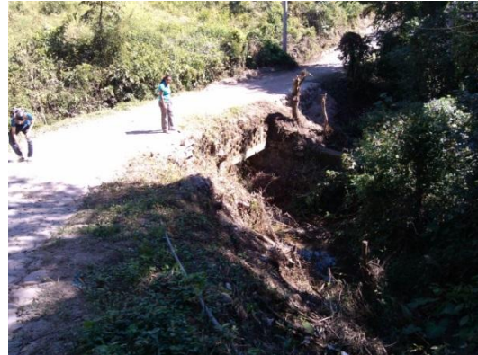
Puente de Quebrada Onda. Infraestructura mal débil, sin construcción técnica
