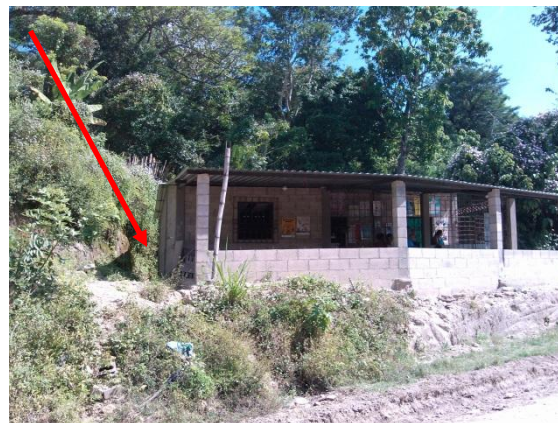
Casa comunal en riesgo por deslizamientos Caserío Los Peña. Tablón
