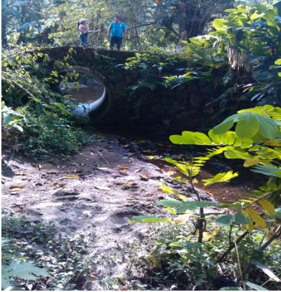
Obra de paso insuficiente Calle hacia Caserío El Tránsito
