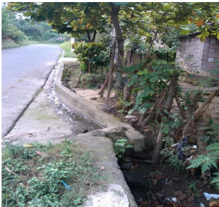
PR-1. Canaleta obstruida por basura Comunidad María Auxiliadora, Cantón El Tablón
