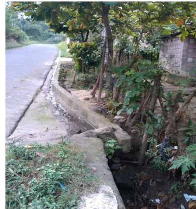
Canaleta obstruida por basura Comunidad María Auxiliadora, Cantón El Tablón
