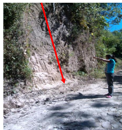
Susceptible a derrumbe Calle a San Jose El Sitio
