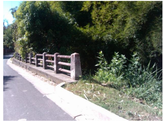
PR-33. Riesgo por cárcava en el sector Barrio .Democracia Colonia Jardines de Tenancingo
