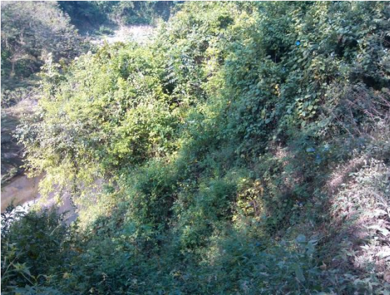
PR-23. Deslizamientos y desprendimiento de piedras y barro, cantón Ajuluco.
