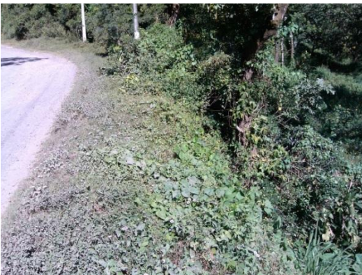
Puente sin Borda o valla de protección Caserío Masacuayo, Cantón Jiñuco
