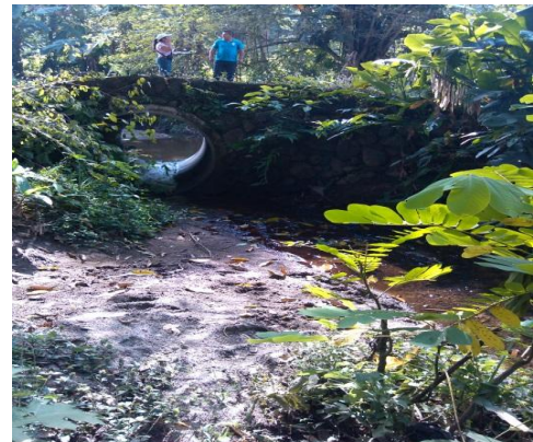
PR-3. Obra de paso insuficiente Calle hacia Caserío El Tránsito
