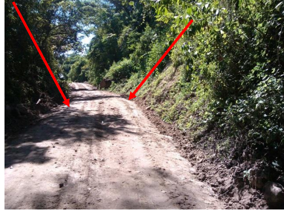
Susceptible a derrumbe en calle a Ajuluco
