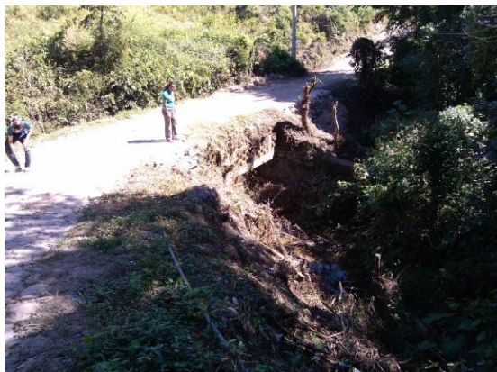
PR-19. Puente de Quebrada Onda. Infraestructura débil
