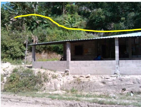
Ladera propensa a derrumbes Caserío Los Peña, Tablón Abajo
