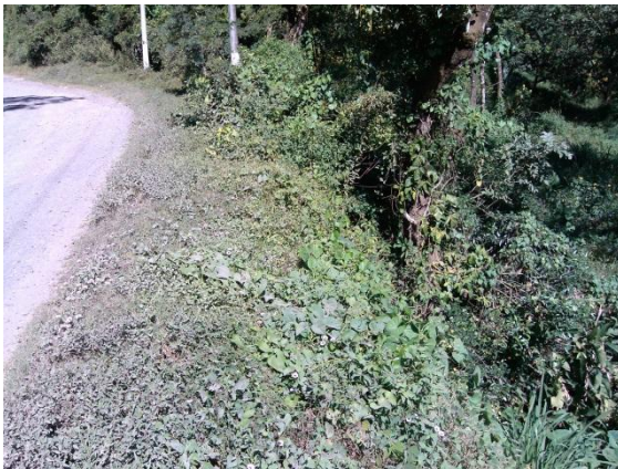
PR-15. Puente sin Borda o valla de protección Caserío Masacuayo, Cantón Jiñuco
