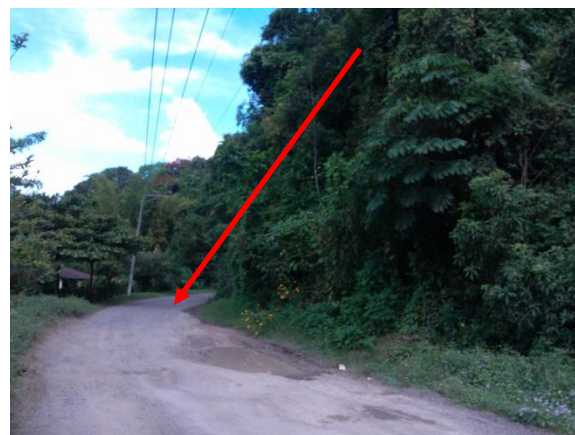
Deslizamiento de tierras Caserío Los Peña, Tablón Abajo viviendas en riesgo
