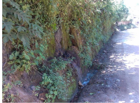
Susceptible a derrumbe Cantón El Pepeto con viviendas en riesgo
