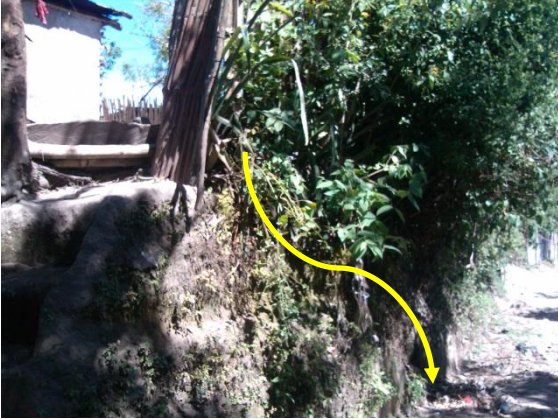
Susceptible a deslizamiento Calle a San Jose El Sitio
