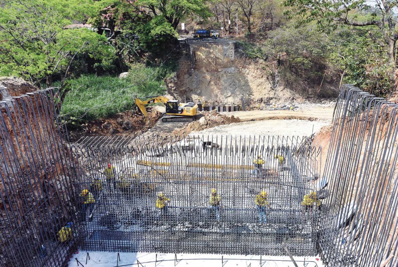
Obra de paso. Trabajadores durante ejecución de puente La Palma, en Chalatenango.
