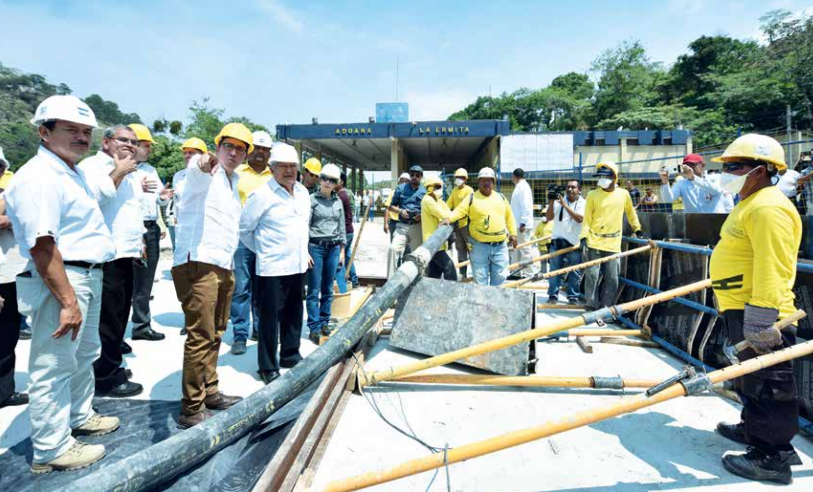
Puente Anguiatú, Metapán. Nuevo puente de 40.44 una apuesta nacional de logística e integración regional
