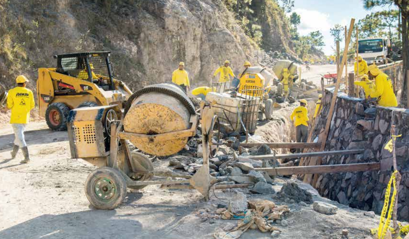
Carretera Cantón Tejera, Paso del Mono, Arambala. Ejecutado como parte de donación del Fondo de Inversión para América Latina (LAIF) para fortalecer la red rural en materia de seguridad vial.
